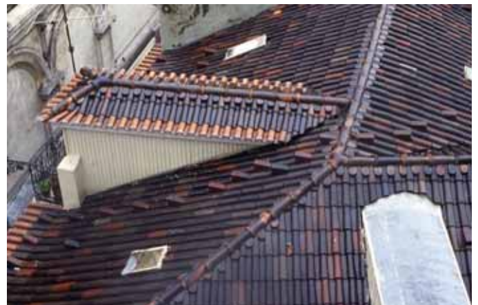
Les bâtiments réhabilités devraient être assortis de mesures pour faciliter leur entretien ultérieur de manière sûre et économique. Toit muni de pièces spéciales pour garantir les parcours d'entretien, Lisbonne (Portugal).
