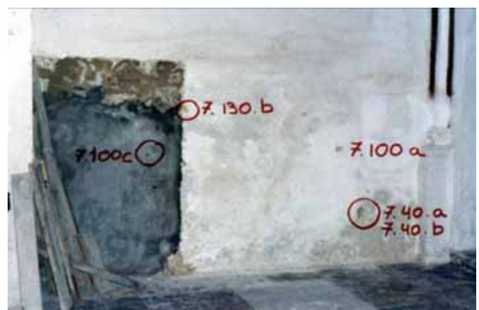
Détérioration des revêtements.
