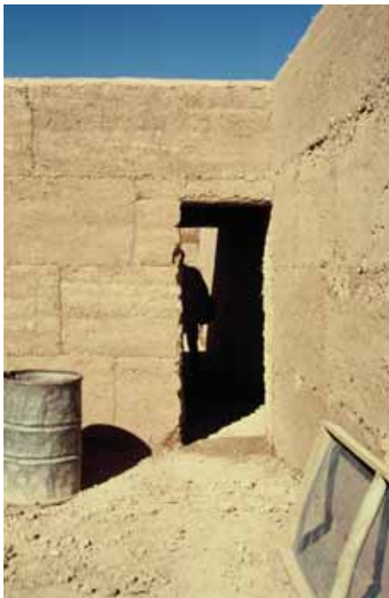
Dans le monde rural du sud du Maroc, la construction de logements continue de nos jours à être effectuée avec des murs de terre selon le système traditionnel. Vallée du Dadès (Maroc).
