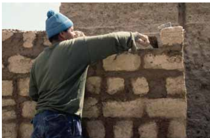
Construction d'un mur d'adobe réalisée par un constructeur local (maalem). Vallée du Dadès (Maroc).
