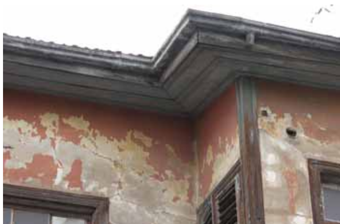
Façade dont les effritements permettent de découvrir les changements de couleur du bâtiment en fonction des goûts des différentes époques (Nicosie, Chypre).
