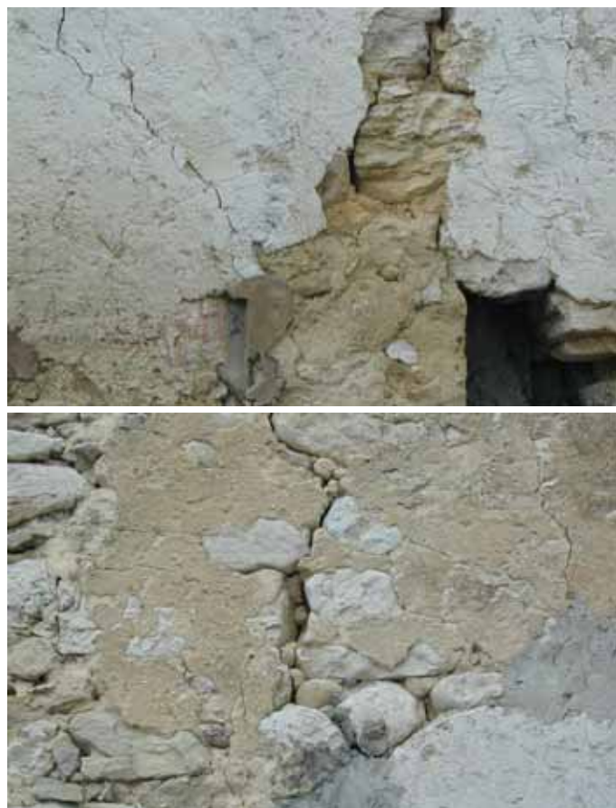
Lézardes qui entaillent l'épaisseur du mur
