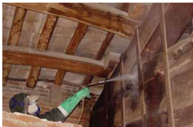
Pulvérisation superficielle d'un noeud structurel.
