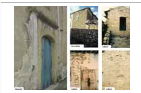
Décollement et crevasses du plâtre
