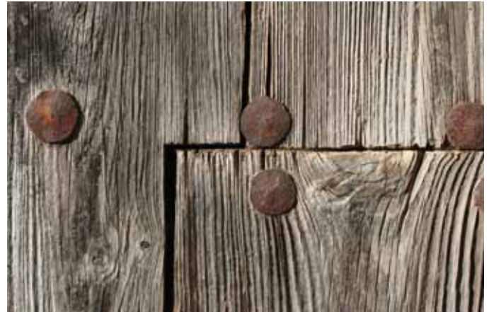
Dégradation abiotique du bois.
