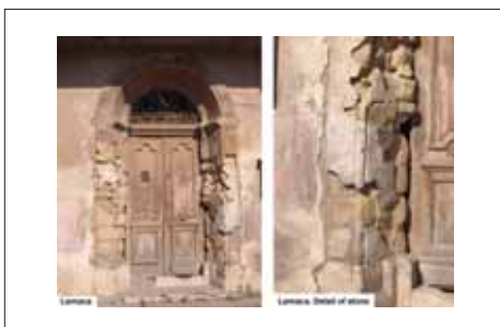
Dégradation de la pierre
