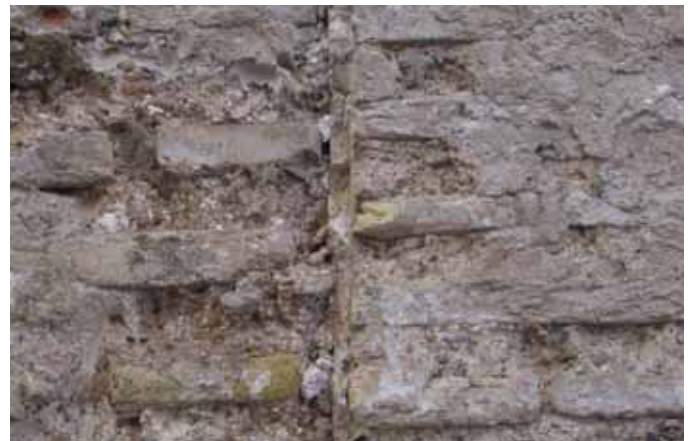
Le mortier indique que le mur de gauche s'adosse au mur de droite.
