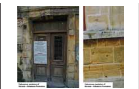
Dégradation de la pierre
