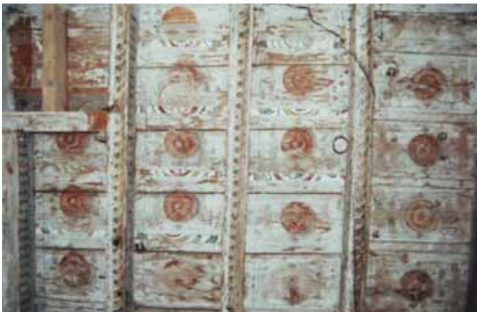
Planches d'un plafond à caissons polychrome qui présentent une double couche de peinture et les traces de leurs différentes positions par rapport à leur position initiale.
