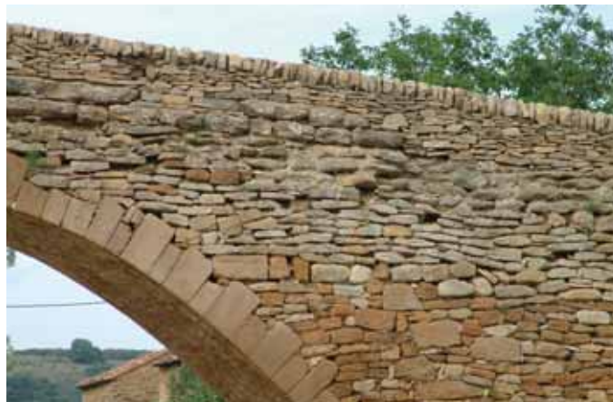
Unités stratigraphiques dans le pont de la Pobleta de San Miguel (Villafranca del Cid, province de Castellón, Espagne). Chaque unité stratigraphique se distingue par la technique constructive employée.
