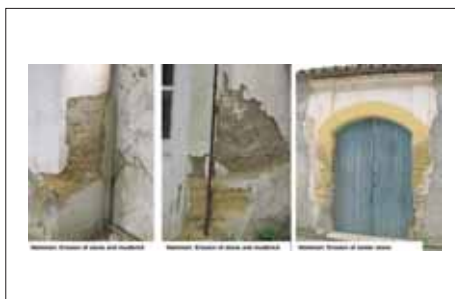
Dégradation de la pierre et de l'adobe
