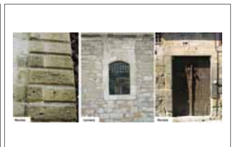
Dégradation de la pierre
