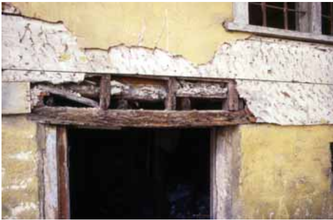
À l'extérieur, éléments donnant l'impression de très mauvaises conditions physiques
