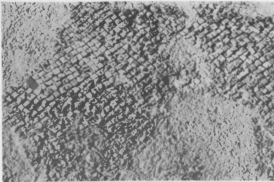
Aquileia, Scavo all'aperto del fondo demaniale CAL, pavimento in cotto strappato e rimesso su letto di cemento trent'anni fa. Il cotto si sgretola per l'azione del gelo.
