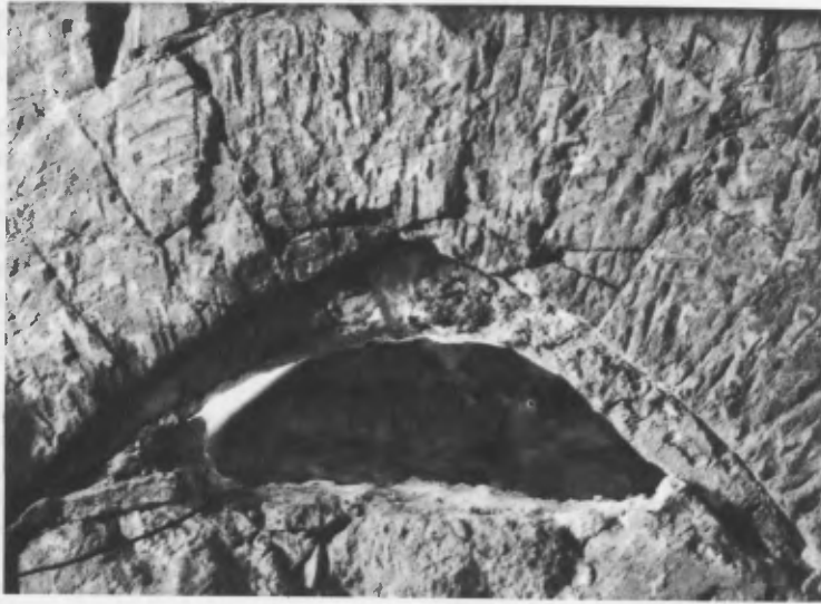
Fig. 1. - Paramento murario con tracce di scalpellature.
