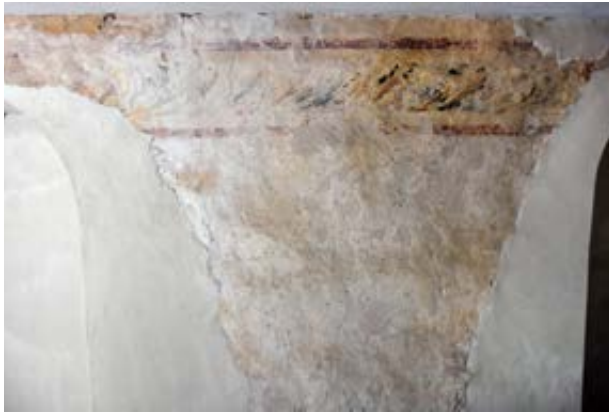
19 Wandmalerei auf der Südwand im Erdgeschoss des Westwerks: Veränderung der Oberflächen durch silikatische Festigung (Verbräunung) und Schleierbildung (Calciumsulfat), 2018
