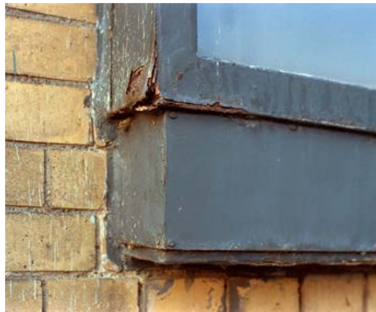
4 Korrosionsschäden an den Fenstern des Hauptgebäudes, Zustand 1984 Corrosion on the windows of the main building, 1984
