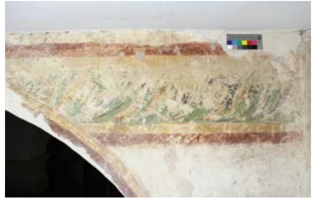
9 Gut erhaltener Farbbefund des Akanthusfrieses, 2019 Erdgeschoss, Südseitenschiff, Nordwand nach Osten
