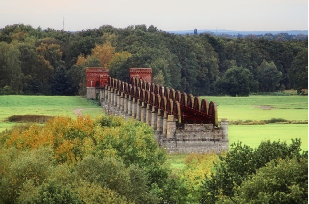
Abb. 7: Gekappte Eisenbahnbrücke Dömitz an der Elbe zwischen Niedersachsen und Mecklenburg-Vorpommern, 2011 (Foto Creativ art CC BY-SA 3.0)
