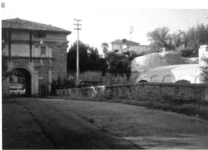
6. Il bastione S. Croce dopo l'impermeabilizzazione della sommità del parapetto, accuratamente studiata ma eseguita in maniera piuttosto grossolana
