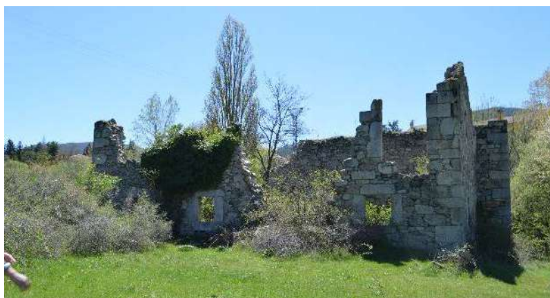
Fig. 2 Molino de mineral del río Gudillos, donde se aprecia su estado de deterioro actual
