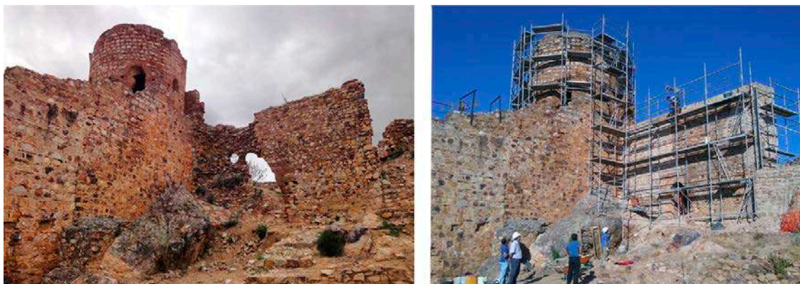
Fig. 5 Proceso de restauración y consolidación de las partes en riesgo de desaparición
