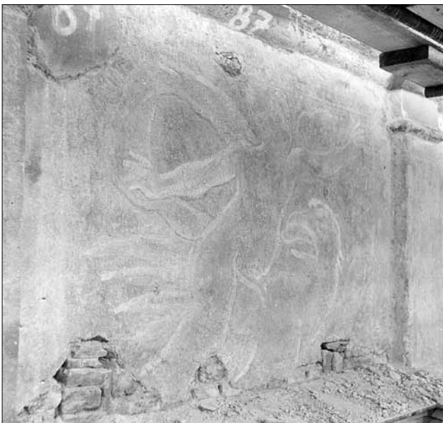
Abb. 11-8a: Litomyšl, Schloss, Westfassade, Bild des Jungen mit dem Adler (Ganymédes), nach Freilegung der Reste der Originals, Foto 1982
