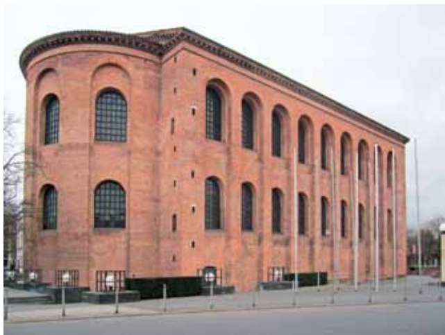
Abb. 8-8: Westwand der Konstantinbasilika mit den Spuren (Schwärzungen und Balkenlöcher) der begehbaren Außengesimse unterhalb der Fensterreihen. Blick von Nordwesten
