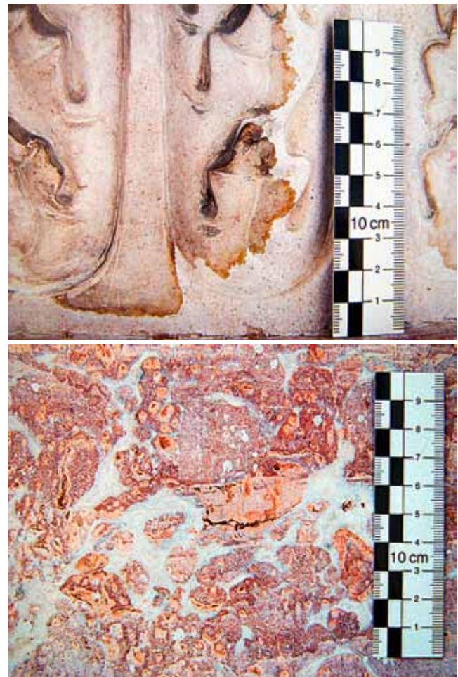
Abb. 6-8: Südliches Eingangsportal des Doms zu Freising. Detail eines Kapitels (links) und einer Pfeileroberfläche mit einbalsamierten braunen Rückständen und rosa Farbresten (Maßnahme von 1972), 1998
