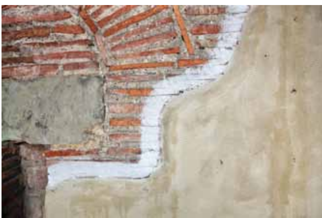
Abb. 14-23: Überputzung mit zweiter Armierungslage. Für den zweiten Putzauftrag sind die Randzonen mit Cyclododecan-Spray abgedeckt.
