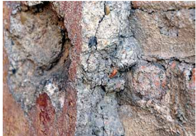
Abb. 7-6: Aufgebrochene Putzkanten auf geschädigtem Ziegelmauerwerk
