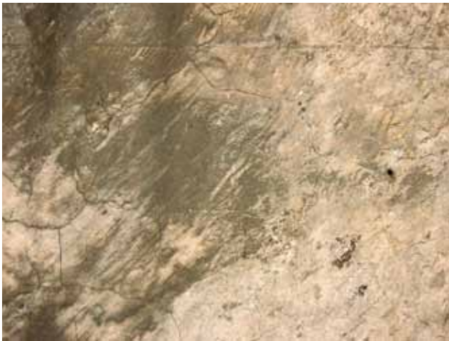
Abb. 10-11c: Oberflächenverschmutzung ist in unterschiedlichen Intensitäten in die Gipskruste eingebunden; Vorzustand; Bildhöhe ca. 25 cm
