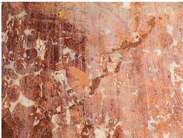
Abb. 6-9: Südliches Eingangportal des Doms zu Freising. Detail der südlichen Säule mit sekundärer Streifenbildung des mit dem Pinsel aufgetragenen Polyesters durch expositionsbedingte Korrosion des Polymerfilms (Maßnahme von 1972), 1998
