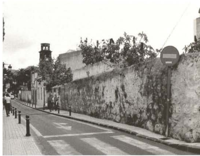
Modificación de alineación prevista en PEP y ya aprobada por el Cabildo Insular, C/San Antonio, Situación actual (julio 2004).
