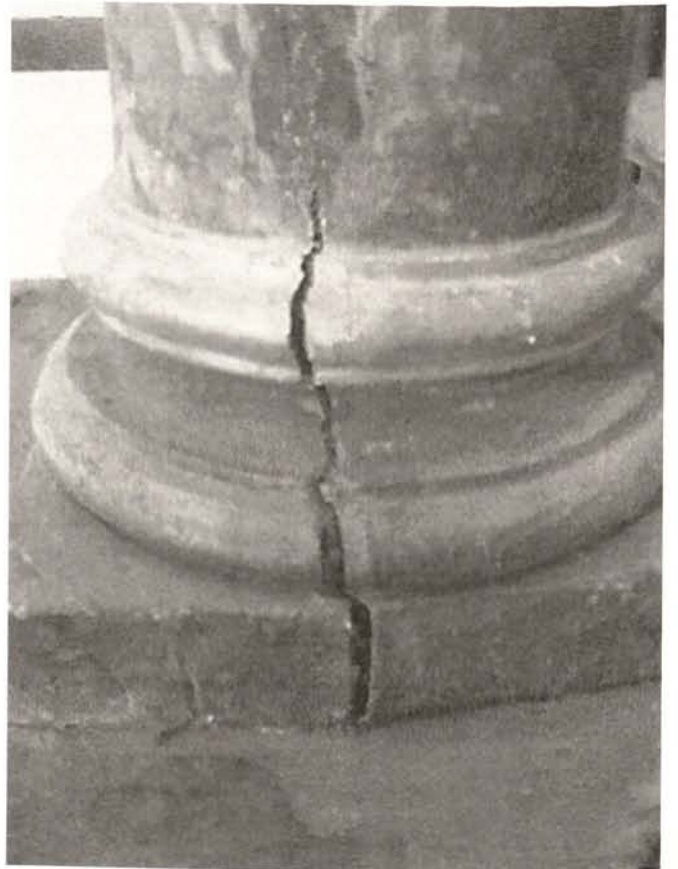
Grietas en estructura por cambios de humedad
