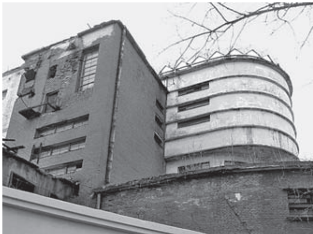
Силовая станция трикотажной фабрики «Красное знамя» в Санкт Петербурге, 1926–1928, арх. Э. Мендельсон. Состояние 2005
