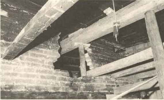
14 Krumbach, Hürbener Schlößchen, Verspannung des Bauwerks vor Beginn der Bauarbeiten nach Gewohnheit der Baufirma ohne Berücksichtigung der Denkmaleigenschaften. Unnötige, erhebliche Beschädigungen der wenigen erhaltenen spätgotischen Wände.
