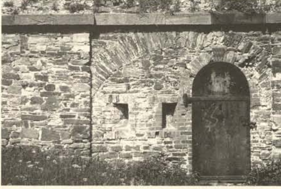
7 „Ausblühen“ von Salz aus einer Mauer (Festung Ehrenbreitstein). Salz wurde im Inneren der Mauer gelöst, in einem Konzentrationsgradienten transportiert und an der Oberfläche durch einen steilen Gradienten im Wasserdampfdruckausgefällt: Irreversibler Vorgang
