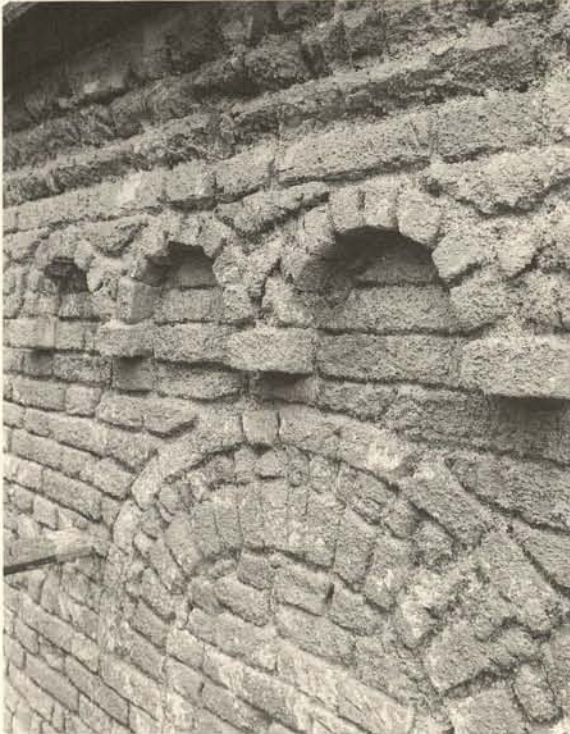
21 Ilimünster, ehem. Klosterkirche, Zerstörung der originalen romanischen Oberflächen der Fassaden wegen Neuverputzung nach VOB. Die Maßnahme ist auch technisch fragwürdig, da diese Verordnung an der Technologie von Neubauten orientiert ist.
