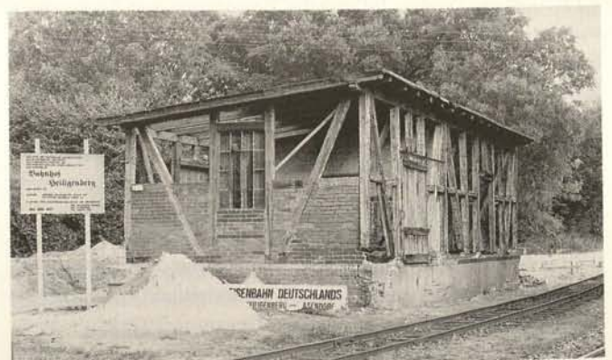
Abb. 23. Heiligenberg, Güterschuppen der Kleinbahn Hoya-Syke-Asendorf: Fachwerkbau mit Pultdach und Kriechkeller (Zustand 1989, während der Erneuerungsmaßnahmen).
