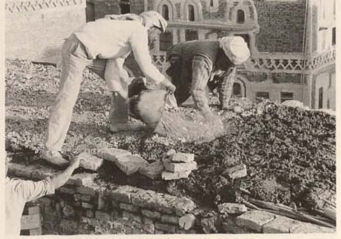
Abb. 25. Trockenschüttung auf feuchter Lehmdecke, 4. Geschloß Fig. 25. Loose fill on the damp clay ceiling of the 4 th floor
