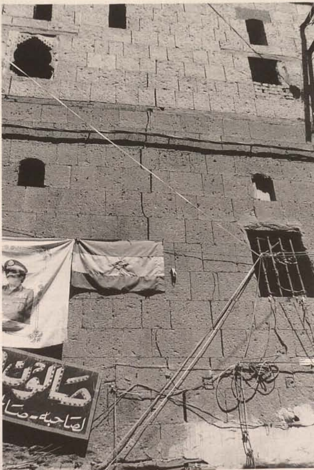
Abb. 15. Südfassade; Riß im Steinmauerwerk Fig. 15. South side; crack in the stone masonry
