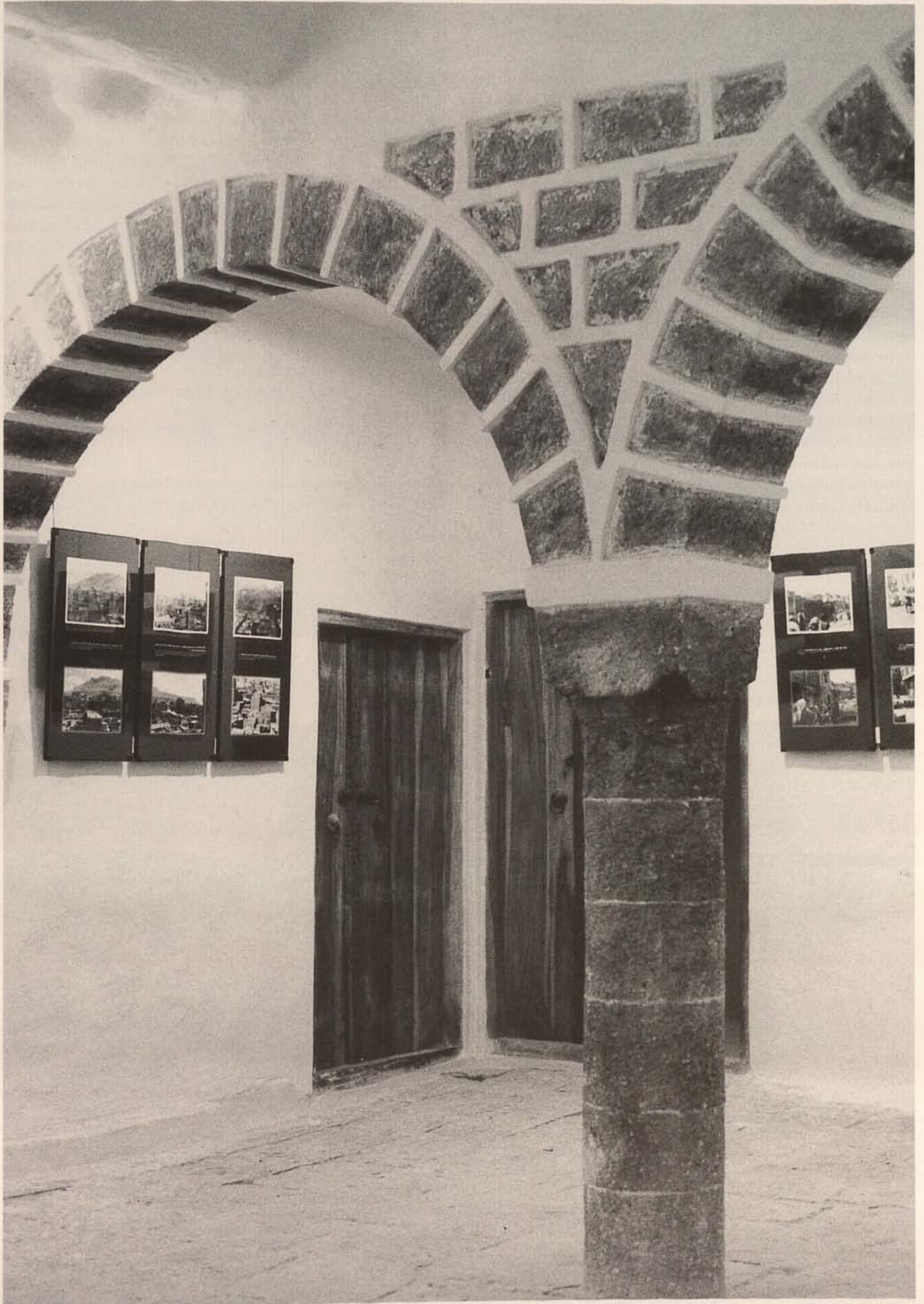
Abb. / Fig. 38. Restaurierte Bogenreihe und Steinboden in der Halle des 2. Geschosses / Restored arches and stone floor in the hall on the 2 nd floor
