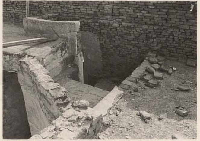
Abb. 70. Verrotteter Treppenaufgang zum Dach mit Qadathresten vor Arbeitsbeginn, von Norden Fig. 70. Deteriorated staircase to the roof with remnants of qadath before work began, from the north
