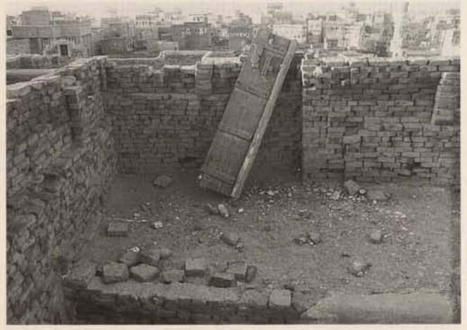
Abb. 14. Verrottetes Brüstungsmauerwerk und undichter Boden in der Dachzone Fig. 14. Decayed masonry on the parapet wall and leaky floor on the roof
