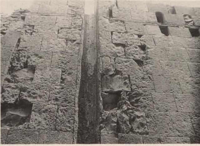
Abb. 13. Ostfassade; verrottetes Steinmauerwerk neben der Abwasser- rinne Fig. 13. East side; decayed stone masonry adjacent to the waste water channel
