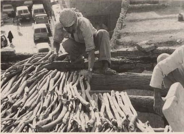
Abb. 22. Einbringen der Knüppelauflage, 4. Geschloß Fig. 22. Installation of the brushwood layer, 4 th floor
