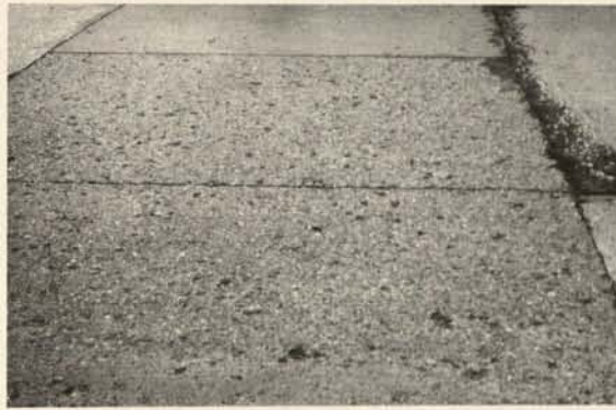
Abb. 2 Durch Frost- und Tausalzeinwirkung geschädigte Oberfläche einer Betonfahrbahn
