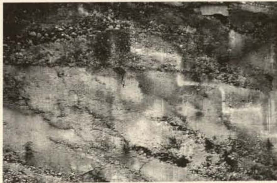
Abb. 3 Kiesnest als Folge einer ungenügenden Verdichtung des Betons
