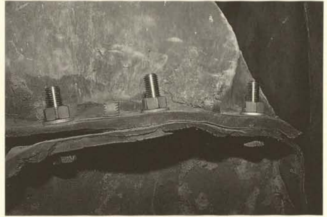
Abb. 6. Montage von Teilformen mit originalen Messingschrauben; Ersatz der durchgerosteten Eisenschrauben durch korrosionsbeständige Titanverschraubungen
