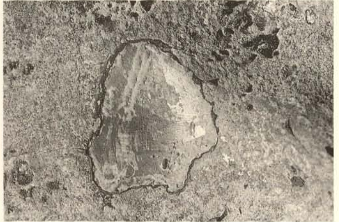
Abb. 8. Rost sprengte Flickung heraus
