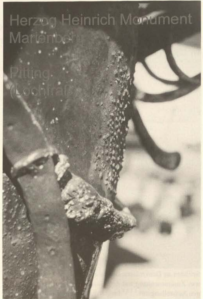
Abb. 1. Marienberg, Detail vom Herzog-Heinrich-Monument: Extreme Korrosionsschäden (Lochfraß)
