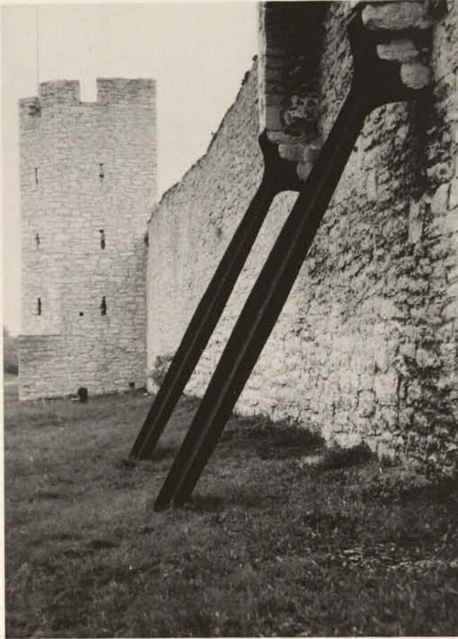
Abb. 5. Gotland (Schweden). Die mittelalterliche Stadtmauer von Visby. Gußeiserne Stützen zur Sicherung eines Zwischenturmes.
