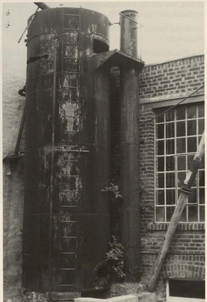
Abb. 11. Der Wasseraufbereitungstank im Fabrikhof: Seine ursprüngliche schwarze Beschichtung war durch jahrzehntelange Freilandbewitterung stark abgewittert.
