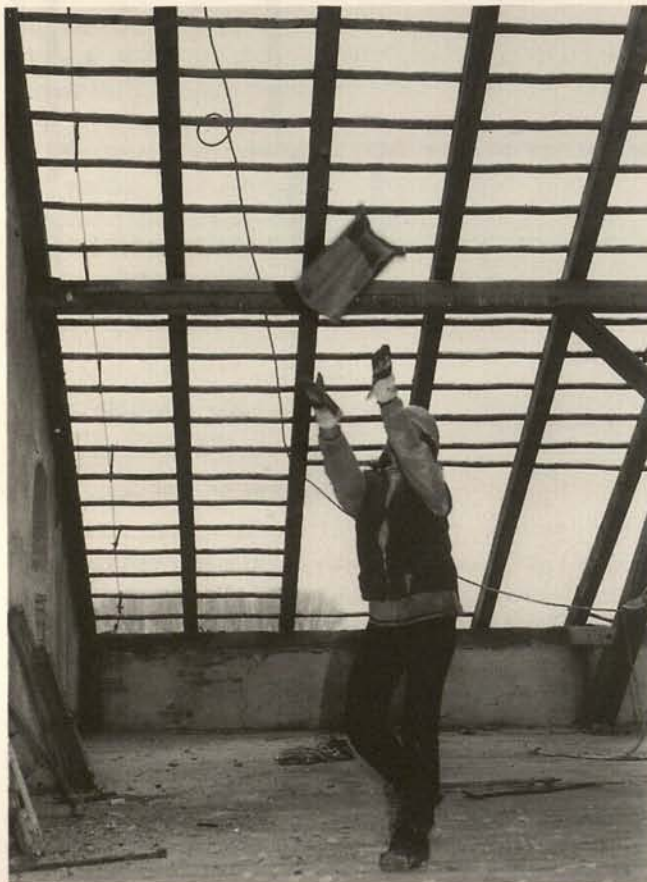
Abb. 11. Abdeckung von Dachziegeln
