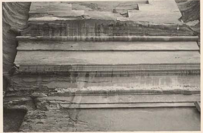
Abb. 8. Wasserschäden durch Sickerwasser
