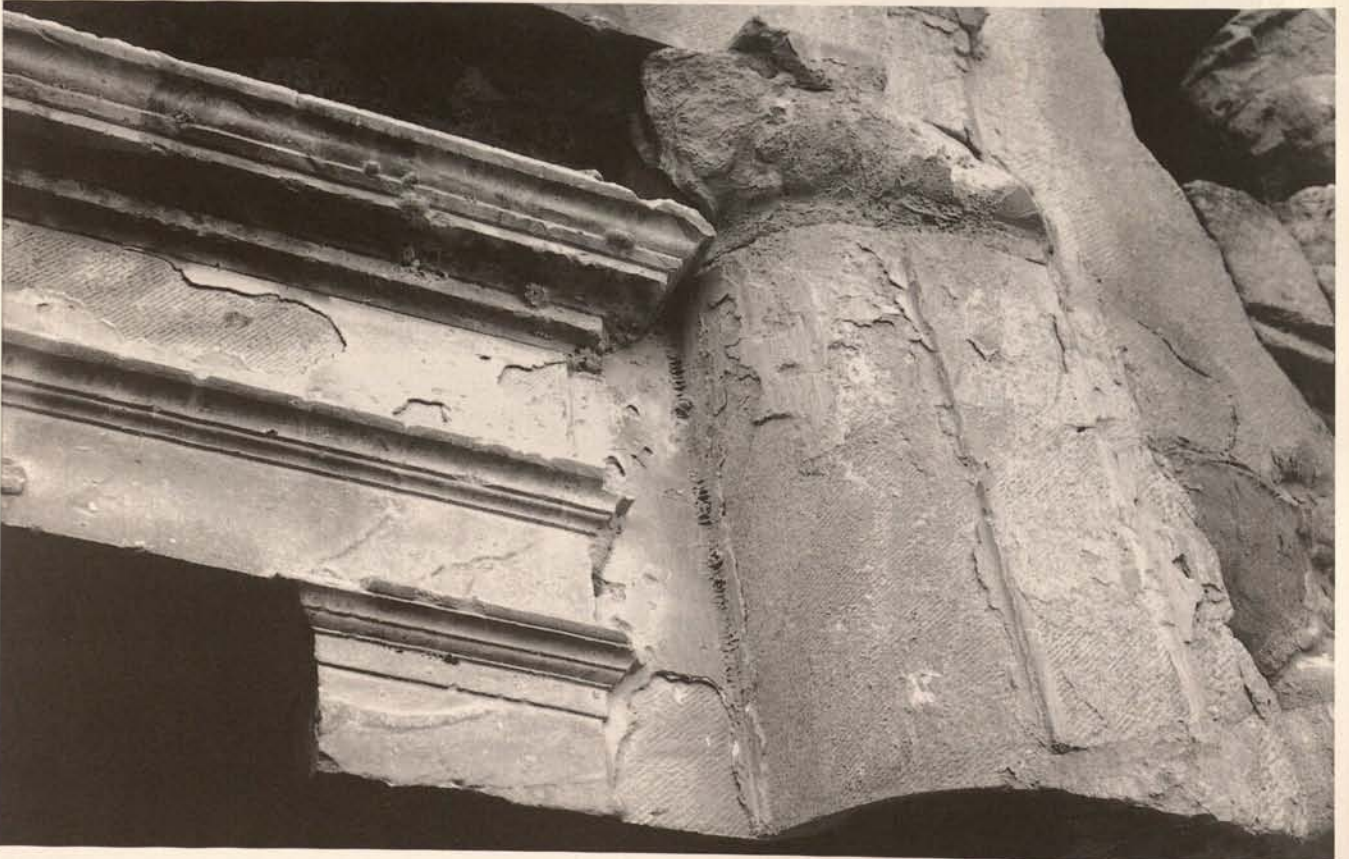
Abb. 2. Grabmonument 676. Putzreste auf dem Türsturz und einem daneben befindlichen Pilaster mit Viertelsäule. Die Spitzeisendressur ist eindeutig Träger des Verputzes / Fig. 2. Tomb 676. Plaster remains on the door frame and a nearby pilaster with quarter of a column. The traces of chiselling with the pointed chisel are unquestionably the support of the plasterwork
