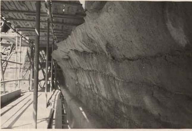
Abb. 9. Zustand des oberen Gesimses
