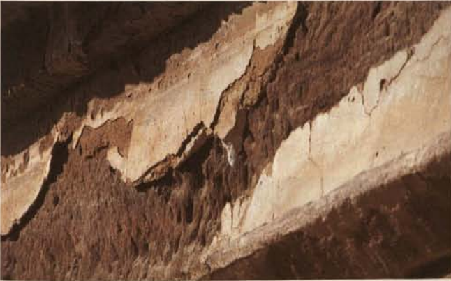
2 Grabmonument 524, Verputz mit Farbbrechen im Gebälk 2 Tomb 524, plaster with colour remains in the entablature
