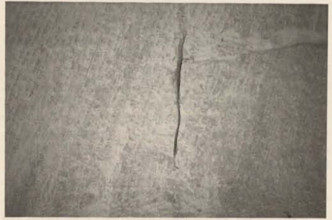
Abb. 7. Riß / Fig. 7. Fissure
