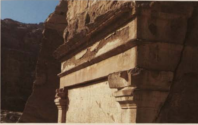
1 Grabmonument 524, Reste des Verputzes 1 Tomb 524, remains of plaster
