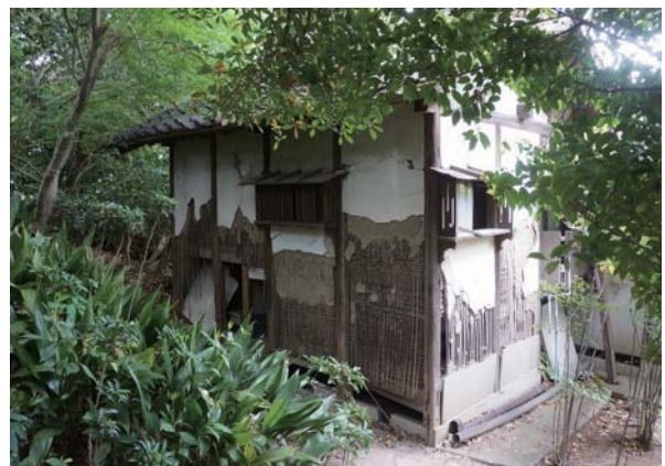
写真 2.9.6 便所 土壁が落ちる
