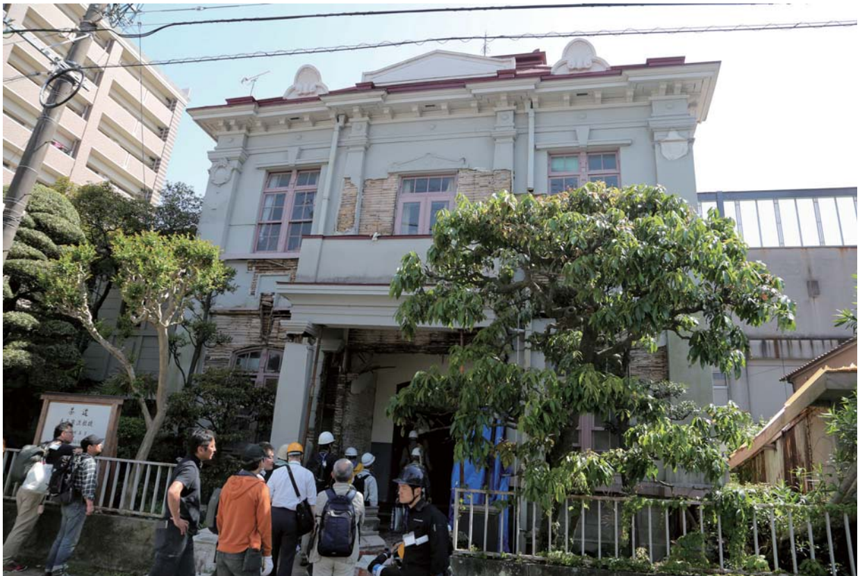
⑫鈴木邸 壁が剥落したファサード
