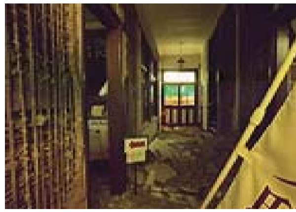
写真 2.5.5 前震による被害状況（内部）
