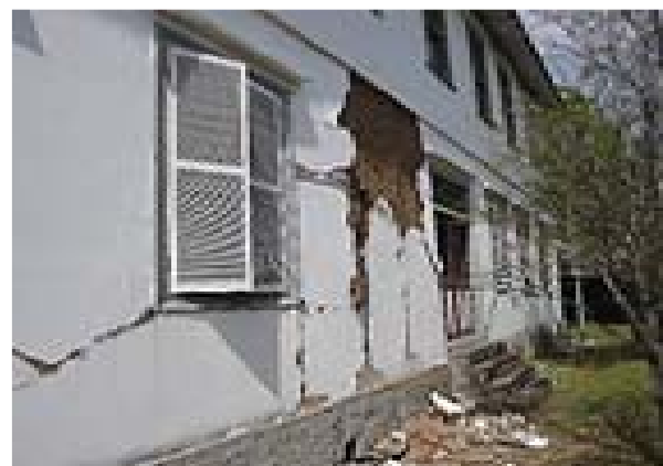
写真 2.5.3 前震による被害状況（背面）
