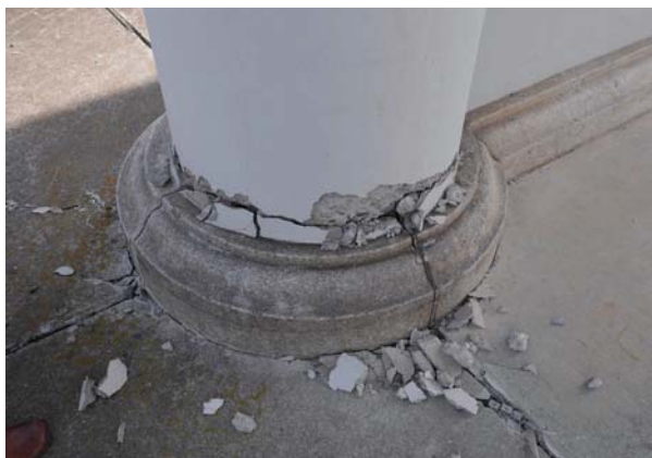
写真 2.14.4 本妙寺仁王門・柱脚の破損（筆者撮影）
