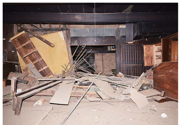
写真 2.2.8 主屋内部・広間 (被災後)
