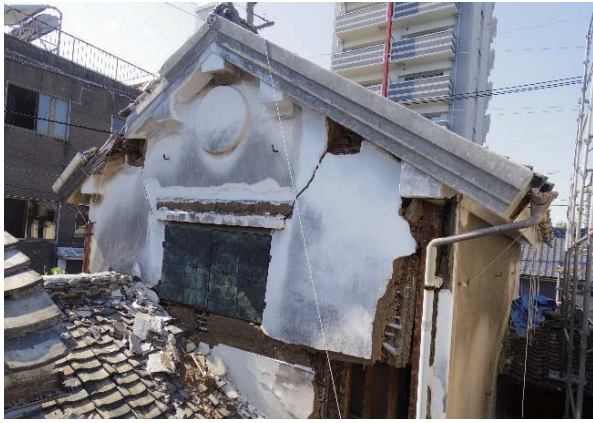
写真 2.6.3 蔵被災状況（南面）
