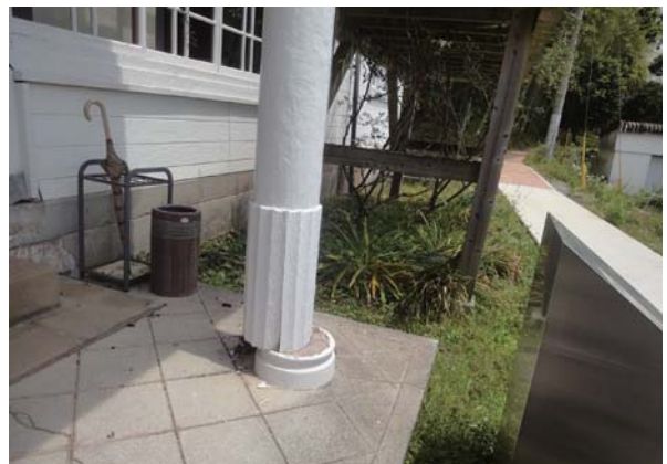
写真 2.17.4 玄関ポーチの柱のずれ
