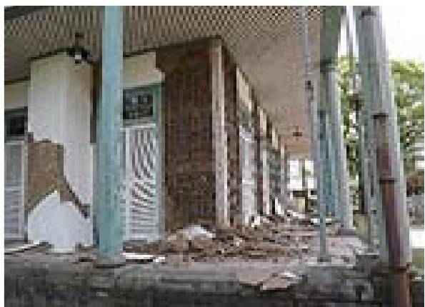
写真 2.5.4 前震による被害状況（正面左）
