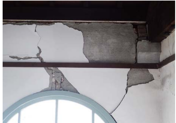
2.13.12 内部アーチ周辺のクラックと漆喰の剥離
