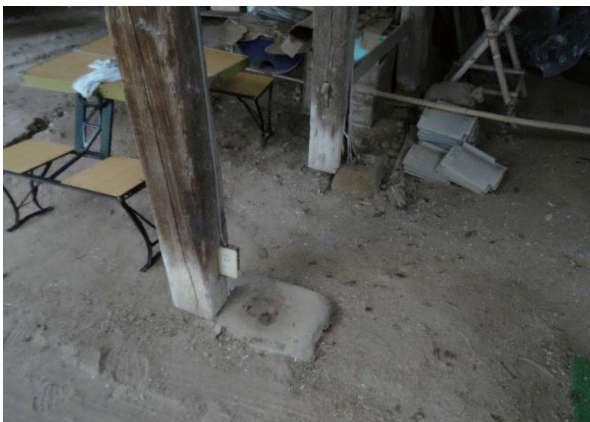
写真 2.3.1.3 矢野家住宅（本宅）・納屋の柱と礎石のズレ
