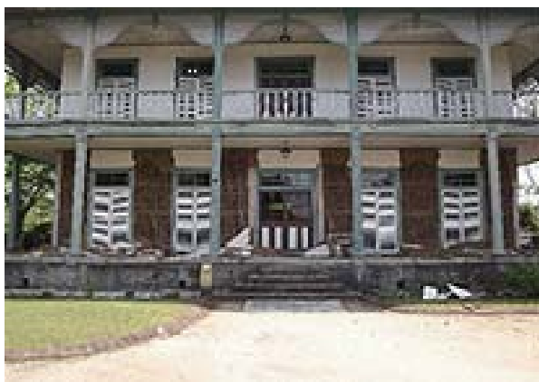
写真 2.5.2 前震による被害状況（正面）
