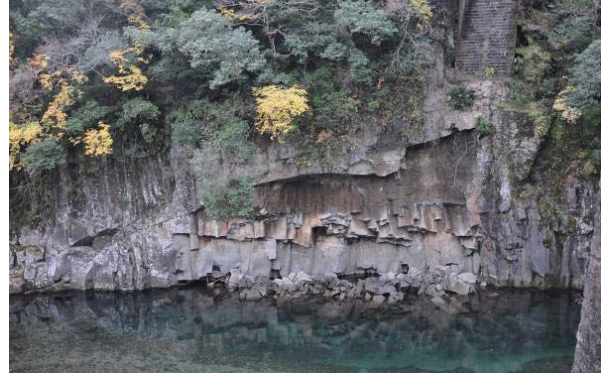
写真 2.18.6.2 崩落部(写真右上が橋台) (撮影: 本田、2016.11.29)
