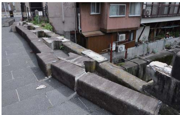
写真 2.18.1.1 倒壊した高欄 (撮影：本田、2016.05.25)
