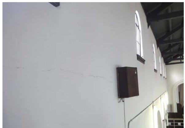
写真 2.17.6 壁に横長のクラック
