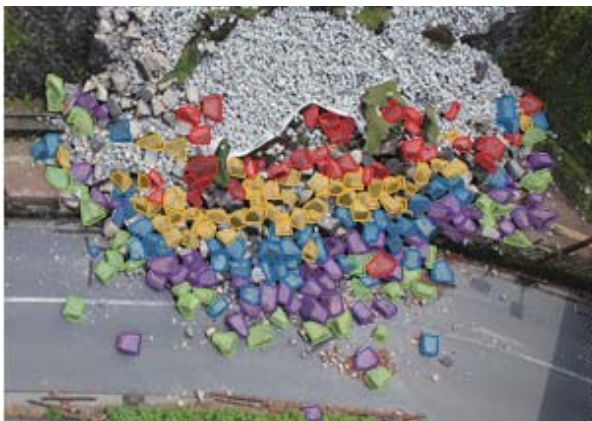
図 2.1.3 宮内の石垣の崩落状況
