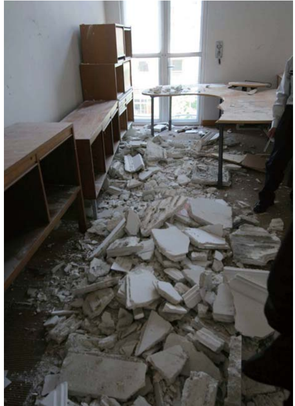
⑩ PS オランジュリ 落下した木摺天井材
