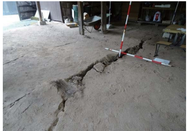
写真 2.3.1.2 矢野家住宅（本宅）・納屋の亀裂
