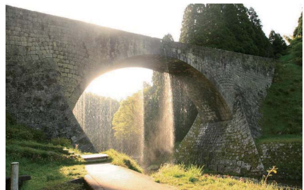
写真 3.7.1 4月16日朝 漏水の状況 (山都町教育委員会)
