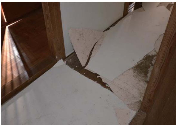
写真 2.3.2.4 矢野家住宅（新宅）・壁の上塗崩落
