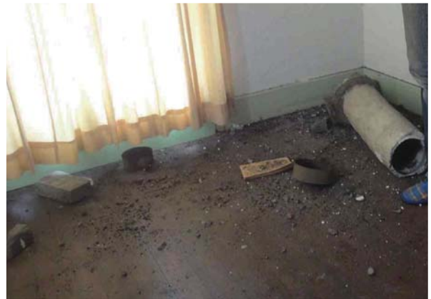
写真 2.17.2 煙突が脱落し室内に落ち込んでいた
