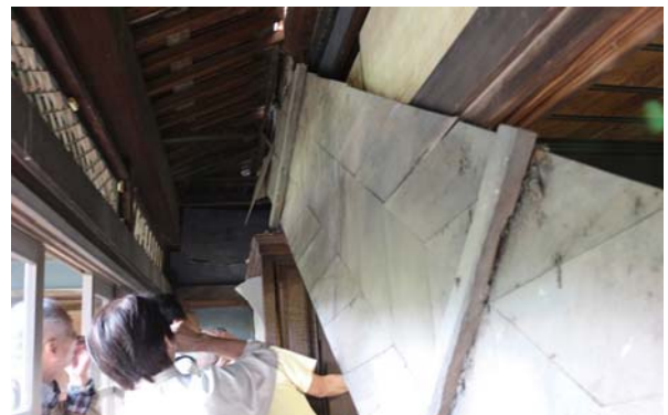
写真 3.3.2 塩屋の縁側の天井が落ちる
