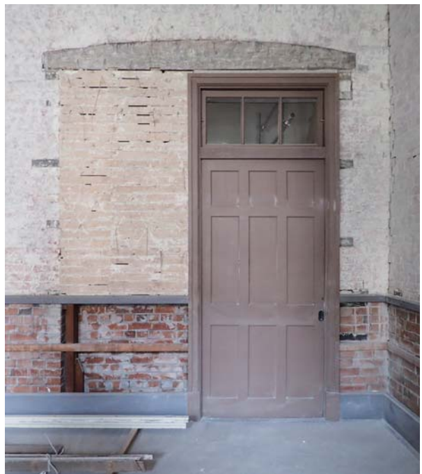
2.13.4 同館修復中の教室内壁
