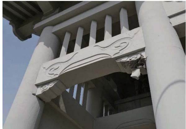
写真 2.14.2 本妙寺仁王門・柱頭・中間梁・肘木の破損（筆者撮影）
