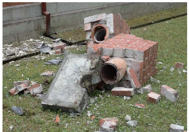
2.13.8 化学実験場の落下した煙突
