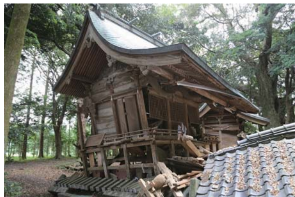
⑥八王社 大きく傾斜した本殿と倒壊した拝殿
