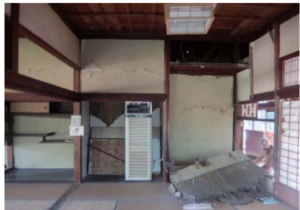
写真 2.11.1 壁はほとんど被害あり。構造体無傷
