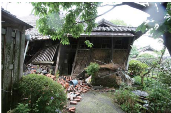
⑤江藤家住宅 柱や壁が著しく傾斜し壁も崩落した裏手
