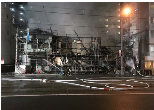
写真 4.2.4 後藤商店火災で焼失 2018.11.16 工事は7割がた進んでいた
