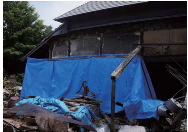
写真 2.9.4 土間北側の倒壊した下屋部分
