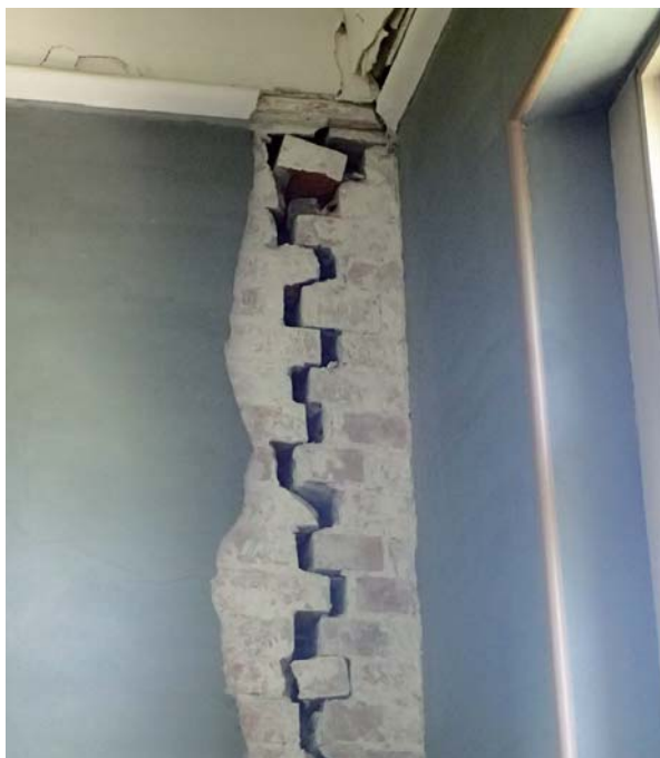
2.13.3 同館2階教室の壁のクラック
