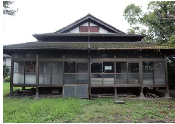
写真 3.2.1 川尻公会堂被災時外観
