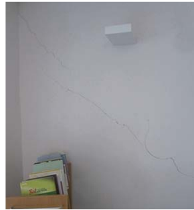
写真 2.12.4 壁面のせん断ひび割れ
