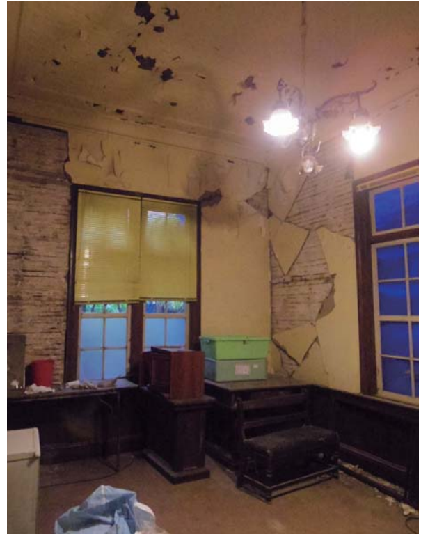
写真 2.8.2 被災後の室内
