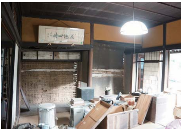
写真 2.9.5 座敷 内部 土壁が落下
