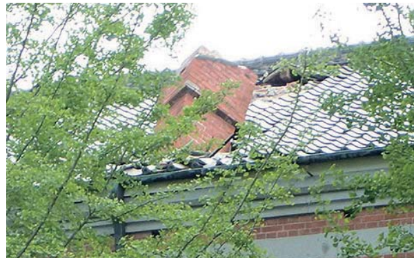
2.13.2 同館の倒壊し屋根に落ちた煙突
