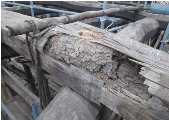
写真 2.2.11 土間上の破損 梁の蟻害が顕著
