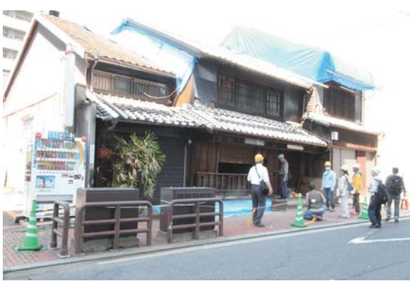
⑨森本襖表具材料店 被害状況の調査
