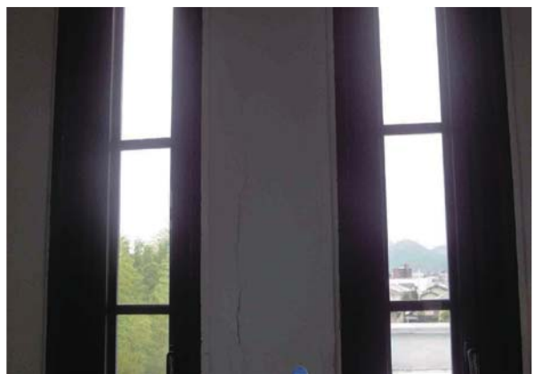
写真 2.17.10 内部塔屋部分壁の一部にクラック
