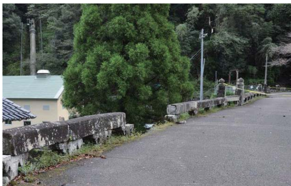
写真 2.18.3.1 高欄落下箇所 (撮影: 本田, 2016.09.20)
