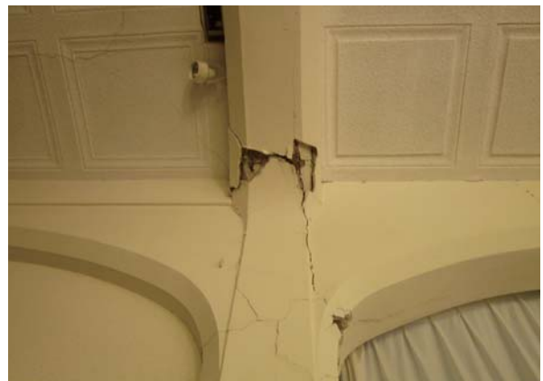
写真 2.17.8 礼拝堂内の柱型にクラック
