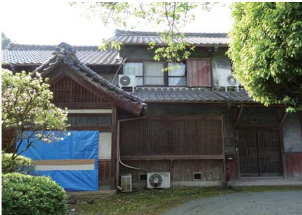
写真 2.3.2.1 矢野家住宅（新宅）被災後
