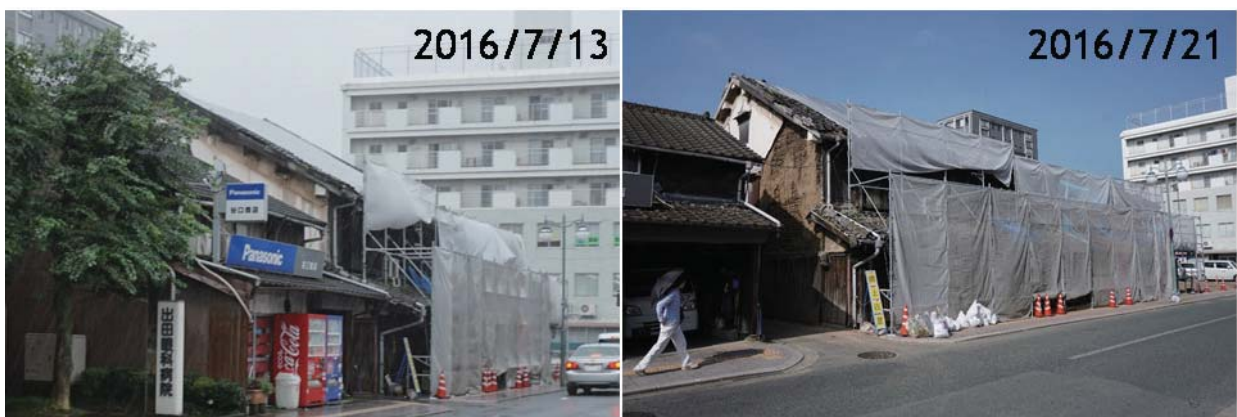
写真 5.1.1 土壁崩落前後の清永本店
