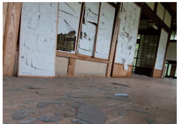
写真 2.11.2 障子紙は炸裂し、ガラスは割れた
