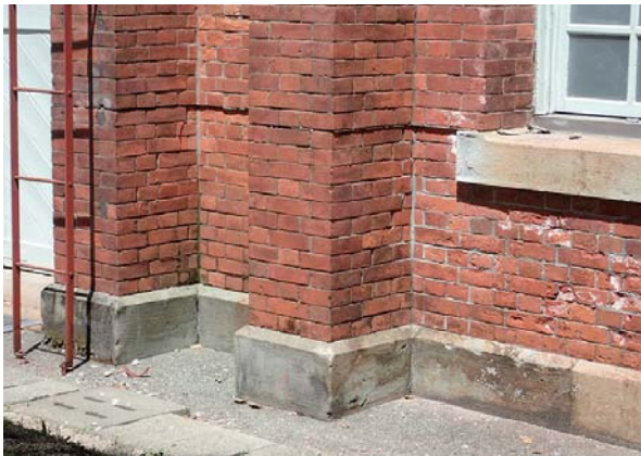
2.13.11 南側壁の水平クラック
