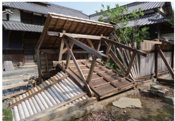
写真 2.3.1.4 矢野家住宅（本宅）・中の門の倒壊
