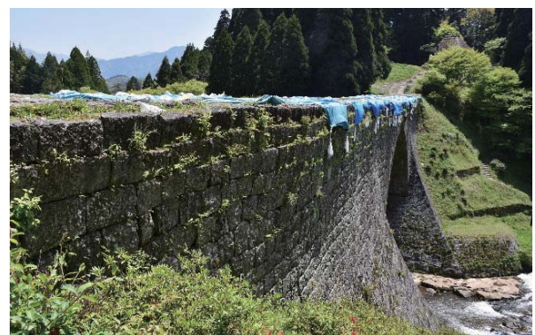
写真 3.7.2 4月20日昼 袖壁のはらみ出し (田中)
