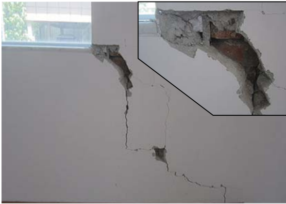
写真 2.12.3 開口部に生じたひび割れ
