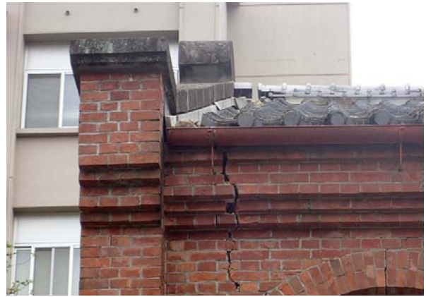
2.13.10 同館四隅壁上部のクラック
