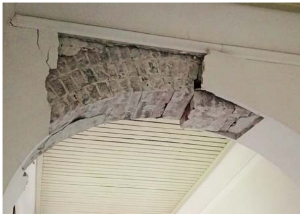
2.13.5 同館2階廊下横断アーチのクラック
