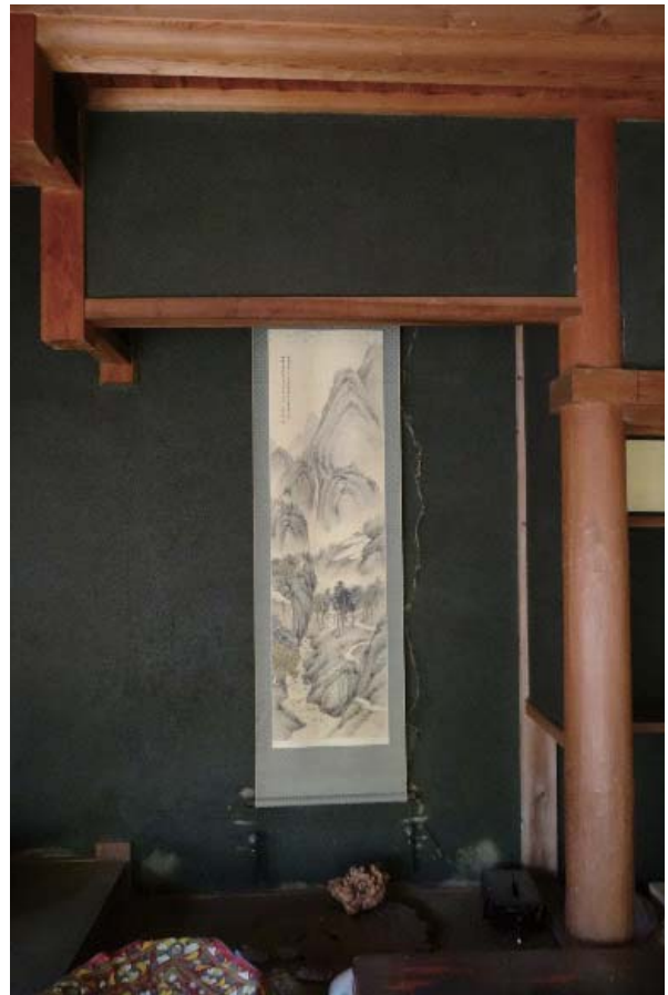
写真 2.3.2.3 矢野家住宅（新宅）・トコ壁の亀裂
