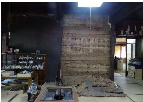
写真 2.3.1.5 矢野家住宅（本宅）・主屋 オモテの壁崩落
