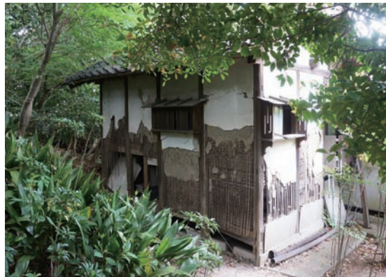
Photo 3.1.10.6 The toilet: Collapsed earth wall.
