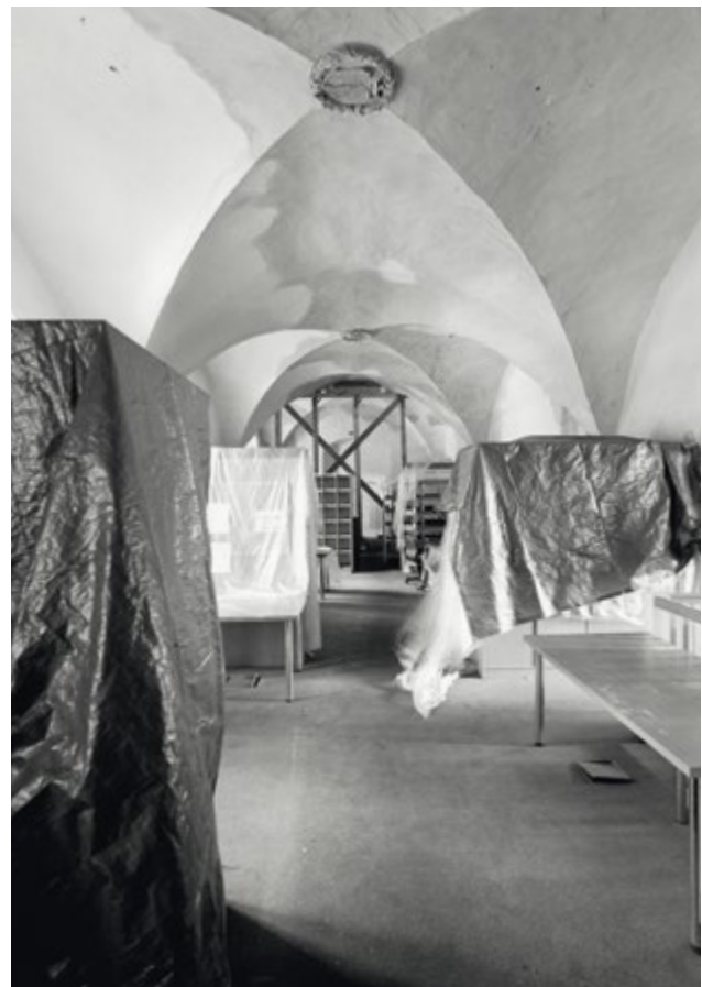
Abb. 4 Östlicher Renaissancesaal im Erdgeschoss, Löschwasser sickert durch die Gewölbedecken, 2004
