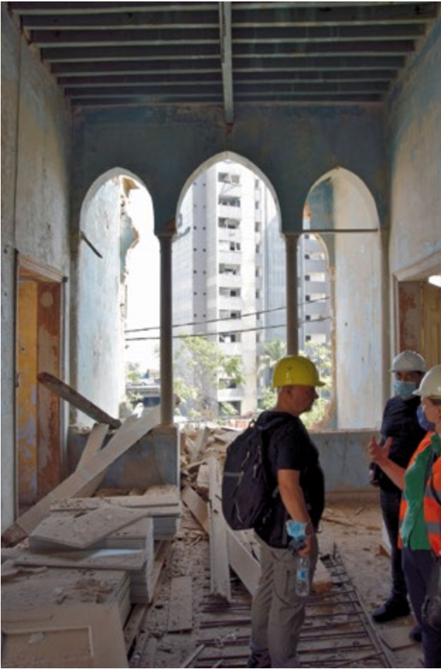
Abb. 2 Besprechung in ME749, die fehlende Fassade gibt den Blick auf den Ort der Explosion frei
