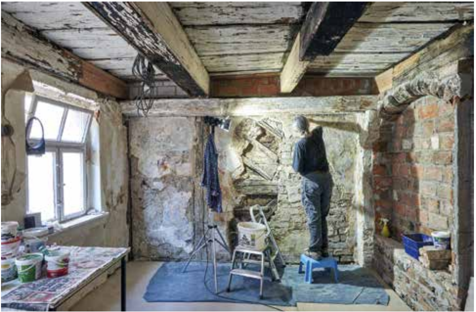
Ressourcenschonend und handwerklich versiert raprieren – Konservierungs- und Restaurierungsarbeiten am spätgotischen Pfarrhaus (um 1500) des Reformators Georg Spalatin in Torgau/Sachsen (Deutschland) (Foto Deutsche Stiftung Denkmalschutz, Roland Rossner)
