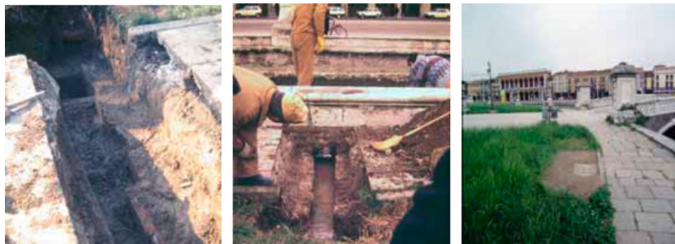
Figura 2.3.: 1985. Prova di pulizia e restauro di uno dei canaletti di scarico dell'acqua piovana nel canale.
