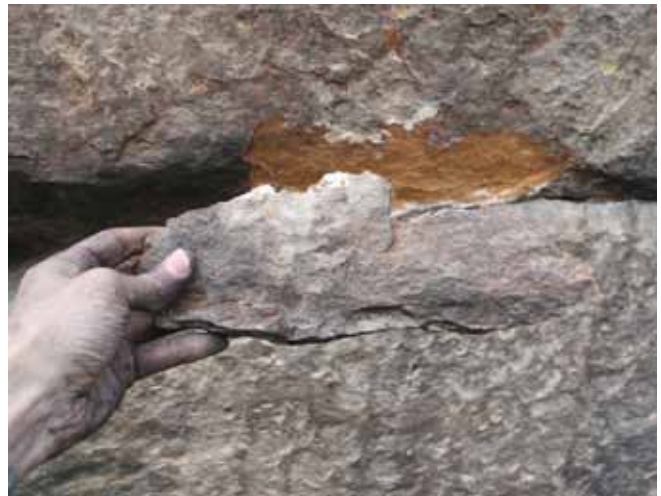
Descascaramiento de la superficie pétreo por fluctuación fuerte de temperatura causada por el incendio. Foto: Diego Martínez Celis, 2014
