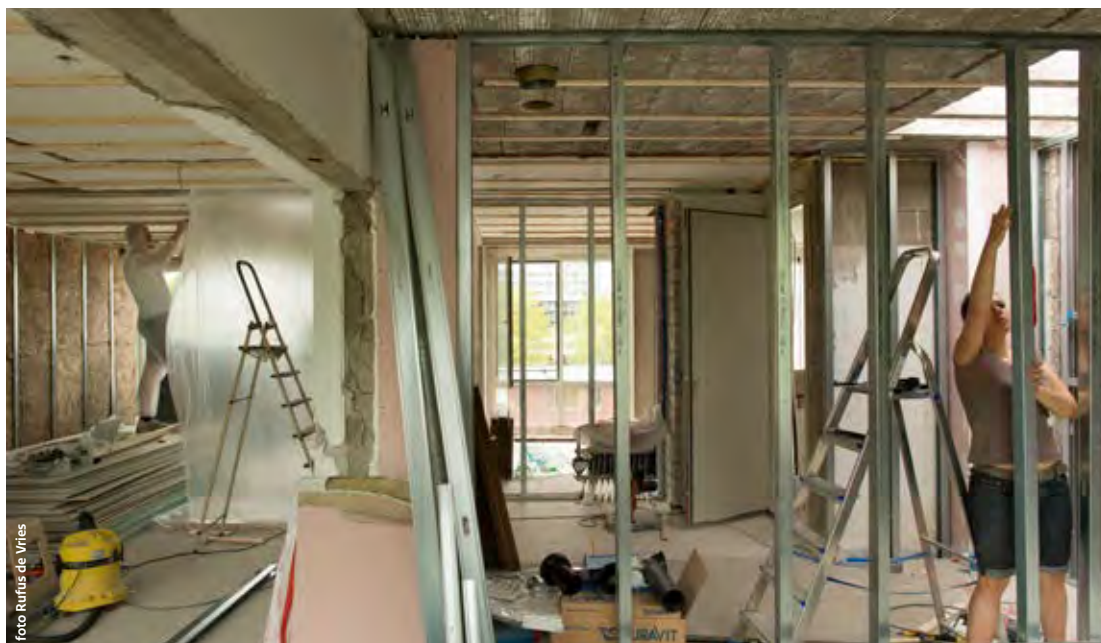
Klusflat Klarenstraat, waar muren zijn doorgebroken en vides zijn ontstaan.
