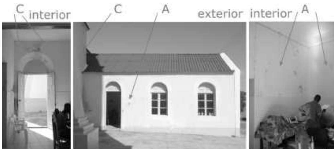
Fig. 16 A causa da humidade no ponto (A) parece ser a má disposição das folhas de fibra-cimento na cobertura do local-acessório respeito aos muros da igreja. É suficiente dispor um controlo de manutenção. As eflorescências no ponto (C) são conseguintes ao fenómeno salino aqui analisado.
