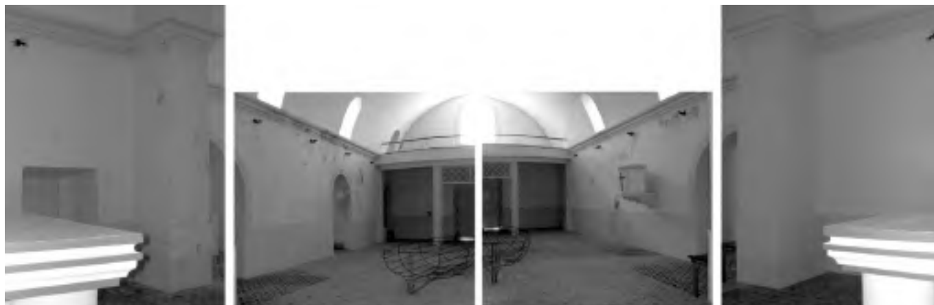
Fig. 17 O mesmo sistema de contra-placar o tecto da sala do edifício religioso perante uma abóbada em estacas de madeira encontra-se na Ilha de Moçambique como por exemplo na Igreja da Saúde. Além do interesse estilístico, esta solução confere ao ambiente um clima confortável. Ademais, esta parte do edifício não sofre nenhum problema de conservação. Duas imagens à esquerda: apesar de ser protegida por um ambiente contíguo, esta parede está contaminada pelo fenómeno aqui tratado pois a chuva entra através do tecto na parte este. O problema das eflorescências superficiais em relação à desagregação presente na face exterior dos mesmos muros tornar-se-á secundário quando for controlada a capacidade efectiva de protecção contra a chuva do sistema de vedação das janelas, que mostra-se não apropriado. Duas imagens à direita: a parede do presbitério não foi atingida pelo fenómeno dos sais pois a respectiva fachada exterior está protegida da chuva por um ambiente contíguo.
