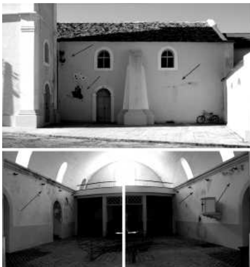
Fig. 11 Igreja de Nossa Senhora da Conceição, parte exterior no lado sudeste e interior do edifícios. Efeito da recristalização dos sais presentes ou induzidos nos muros devido às chuvas batentes. No exterior, devido à temperatura mais alta, a cristalização interessa o muro em profundidade, provocando a desagregação da argamassa e, às vezes, dos blocos de "pedra de coral". Pelo contrário, no interior, sendo mais baixa a temperatura, os sais reproduzem-se só na superfície das paredes em forma de eflorescências. Aqui a última camada de tinta sintética está afastada do reboco, empurrada pelos sais e pelo vapor. Na zona próxima às janelas, todavia, supõe-se que a chuva entre directamente através da base do vão das próprias janelas.
