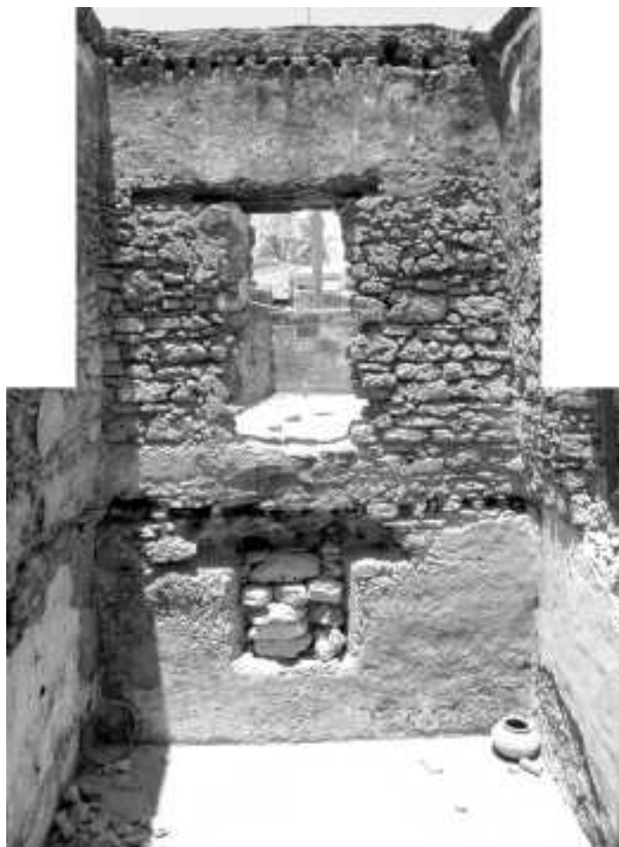
Fig. 18 Antiga casa de pedra coral abandonada na Ilha de Moçambique. Devido à falta do terraço de cobertura, a desagregação dos muros ocorre tanto internamente quanto externamente. A presença desta cisterna, parcialmente escavada no recife coralino, indica que a construção toda está num nível superior ao do oceano e, portanto, não há ascensão de humidade salina.
