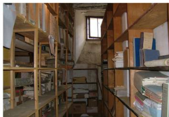
Ambiente adibito fino a tutto il 2006 ad Archivio comunale. Interni durante la fase di trasferimento dell'archivio.
