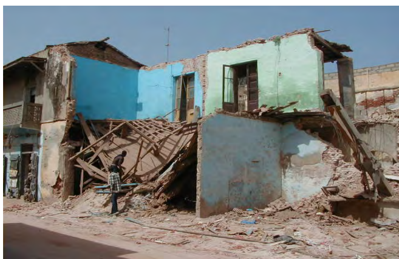
Photographie 4 : Démolition volontaire illégale en cours
