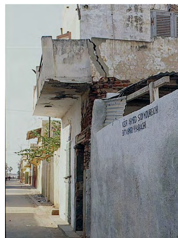
Photographie 1 : Bâtiment en voie d'effondrement
