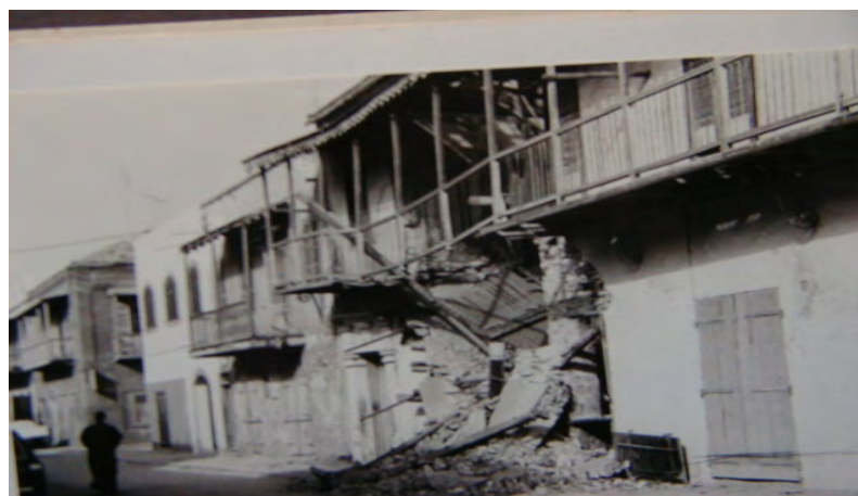
Photographie 2 : Bâtiment effondré
