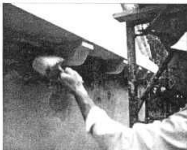
Em cima, colocação de um novo algeroz de pedra de modo a conduzir e drenar as águas pluviais segundo o modelo antigo outrora existente.
