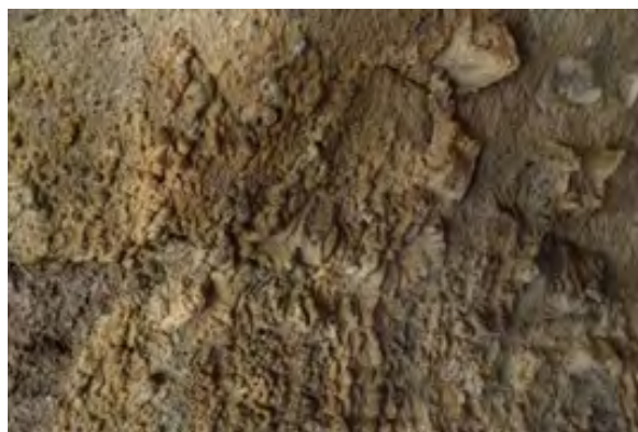
تصویر شماره ۱۵: رسوبات حاصل از رطوبت در رویه‌ی داخلی آسیاب. مأخذ: جوکار، ۱۳۹۸.
