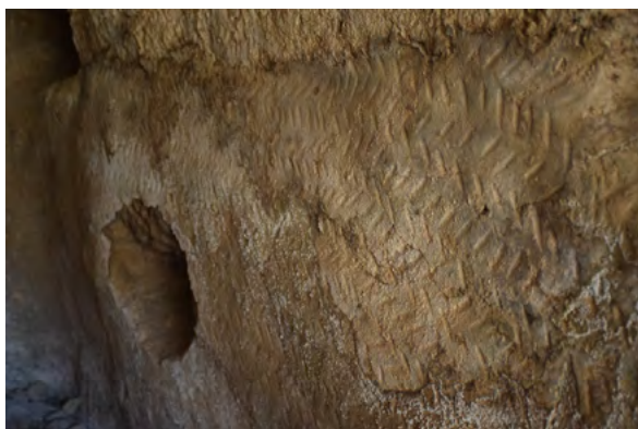
تصویر شماره ۱۶: رسوبات حاصل از رطوبت در رویه‌ی داخلی آسیاب. مأخذ: جوکار، ۱۳۹۸.
