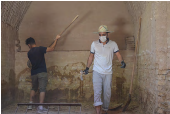
تصویر شماره ۳: پاک‌سازی و لایه برداری از کاهگل‌های فرسوده و آماده‌سازی فضا برای شروع عملیات مرمتی.
