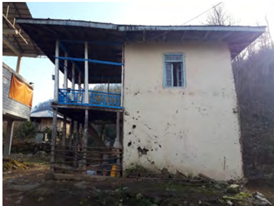
تصویر شماره ۲۵: کنسول کوچک بنا که در حال نابودی است.
