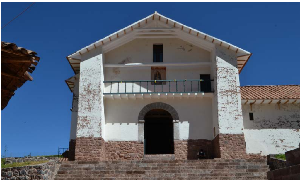
Figura 2 – Fachada principal del templo de Kuñotambo mostrando el deterioro del acabado exterior en noviembre 2020. Fotografía Luís Villacorta Santamato © 2020, J. Paul Getty Trust
