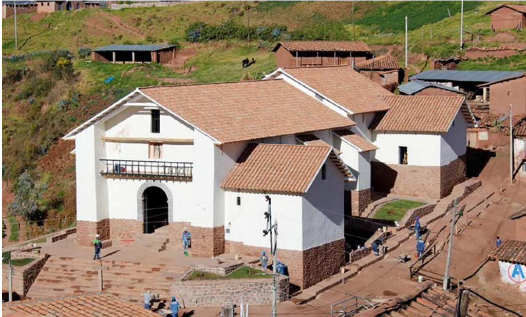
Figura 1 – Vista del templo de Kuñotambo durante los últimos días de la obra de conservación y estabilización sismorresistente en junio 2019. Fotografía Juan Carlos Mellado © 2019, J. Paul Getty Trust y Dirección Desconcentrada de Cultura–Cusco
