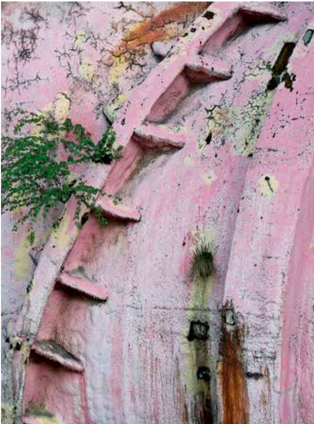
Fig. 3: Polyurethane foam with typical damages, 2013 (© adb Ewerien und Obermann)
