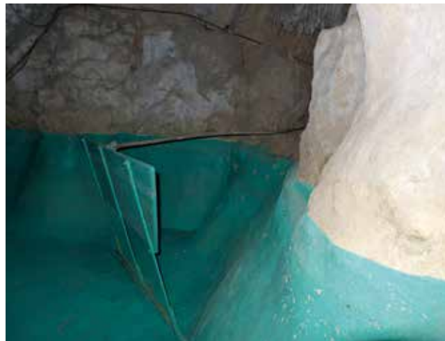
Abb. 11: Das „Wellenbrett“: ein Ruder, das mit Hilfe eines Hebels im Versorgungsgang händisch bewegt wurde
