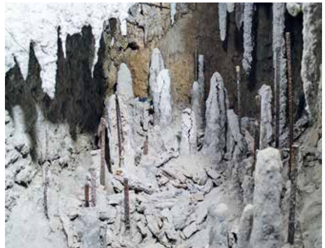
Abb. 5: Durch Korrosion aufgesprengte Stalagmiten mit verstärzten Stalaktiten
