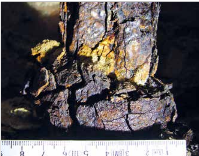
Abb. 4: Detail zur Eisenkorrosion an Knotenpunkten von Tragstäben
