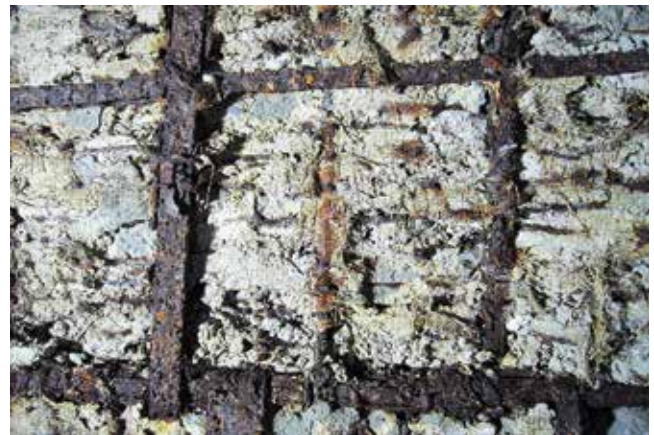
Abb. 3: Extreme Eisenkorrosion an Flacheisen
