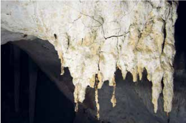
Abb. 6: Durch Rostsprengung beschädigte Sinterfahne
