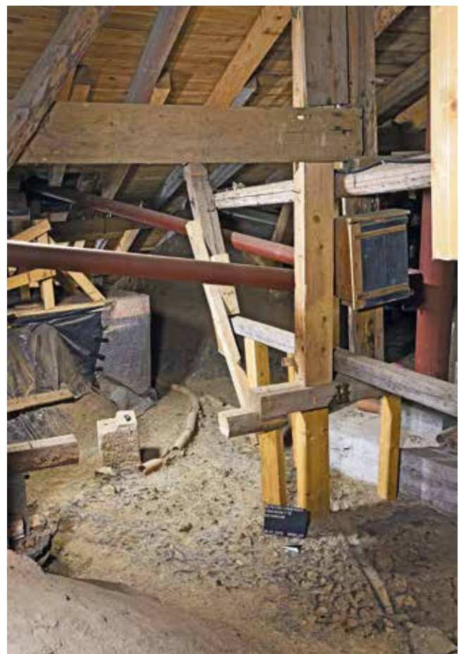
Abb. 7: Grottengewölbe über dem Hauptraum mit der nachträglichen Dachkonstruktion. In dem auf den Gewölbeoberseiten aufgetragenen Teerasphalt sind die zur Ableitung des Oberflächenwassers verlegten Drainagerohre und die Abdrücke der Sickerschicht aus groben Kieselsteinen zu erkennen.
