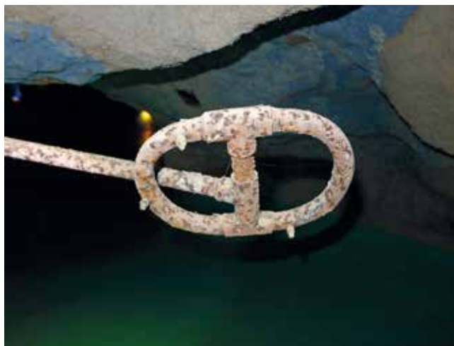
Abb. 10: Sprühkopf zur Vernebelung(?) von Wasser
