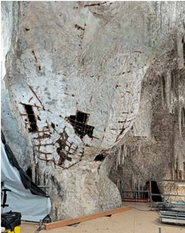
Abb. 8: Schäden an der Drahtputzschale
