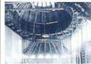
Paralelo a los trabajos anteriores, en el interior de las cúpulas se trabajó en el armado de la mano, las nervaduras han sido encajonadas con un sistema de malla y yeso y en la cúpula central la zona de pretillos ha sido terminada.
