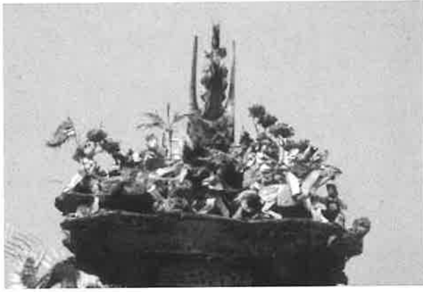
A temple's ridge in Taiwan before restoration Faite d'un temple à Taiwan avant la restauration
