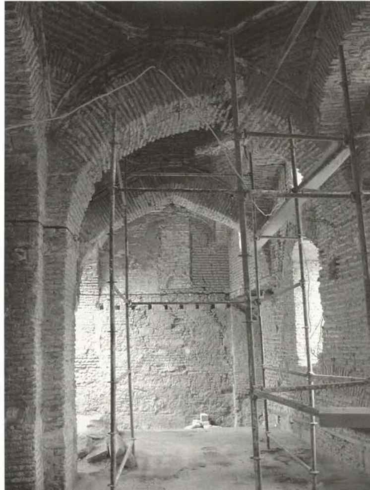
Mosquée Ali Betchin à la Casbah d'Alger. Intérieur en cours de décapage par des procédés mécaniques destructeurs.
