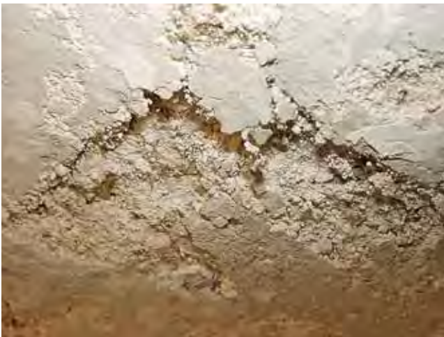
Abb. 17: Auswaschung und „Vermürbung“ des Kalkputzes
