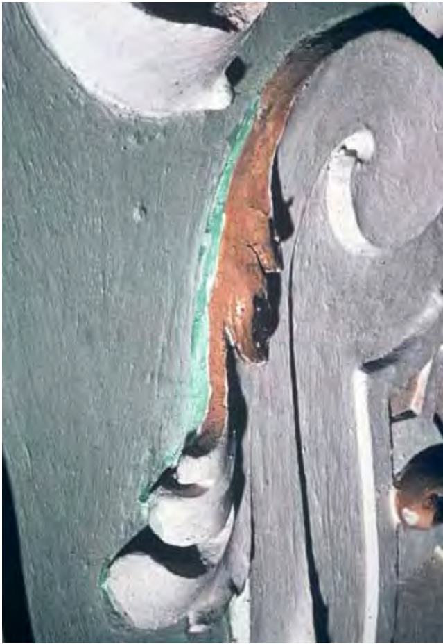
Abb. 4: Steinhausen, Lkr. Oberschwaben, Wallfahrtskirche Unserer Lieben Frau, 1728–1733, Dominikus (Baumeister; Stuck) und Johann Baptist Zimmermann (Deckenbilder), Gurtbogen, Detail, grünlich-graue Überfassung und Reste der bauzeitlichen Grünfärbung.
