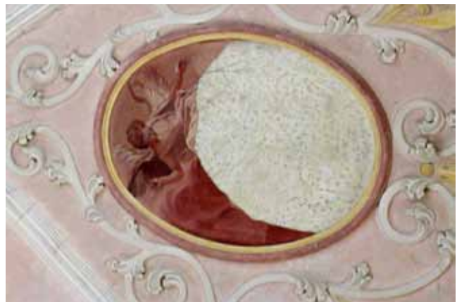
Abb. 3: Pfarrkirche Willprechtzell, die Medaillons und die umrahmenden Stuckierungen wurden in einer zweiten Ausstattungsphase eingefügt. Die Stuckierung der Gewölbegrade ist bauzeitlich. Das Spantengewölbe ist durch zahlreiche Schäden und Zerstörungen der Dachwerke großflächig deformiert.
