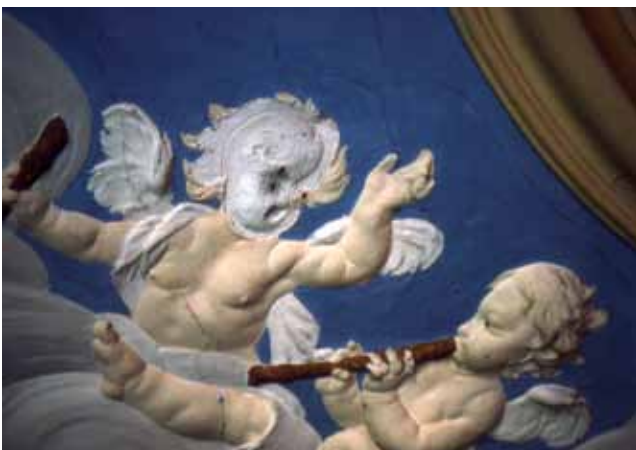
Abb. 1: Garsten, OÖ, eh. Stift, Abtkapelle, Giovanni Battista Carlone 1687: Verlorenes Gesicht zeigt Stuckaufbau – Zustand 1983
