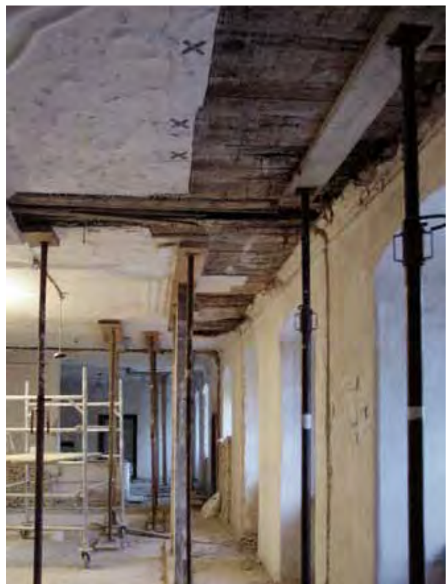
Abb. 6: Nordtrakt, Mönchszelle, Stuckdecke mit Notsicherungen (BDA Mauerbach)
