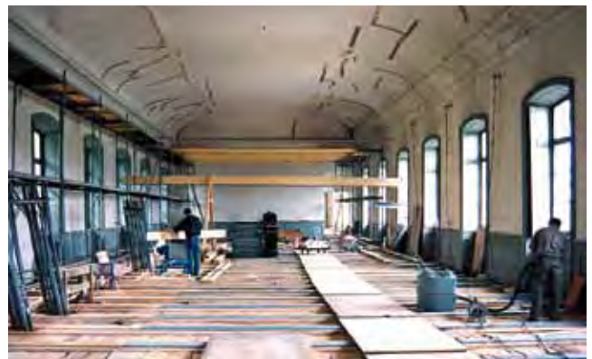
Abb. 17: München, Schloss Nymphenburg, Blick nach Osten in den Hubertussaal nach Abschluss der statischen Maßnahmen und vor Beginn der Restaurierung der Raumschale
