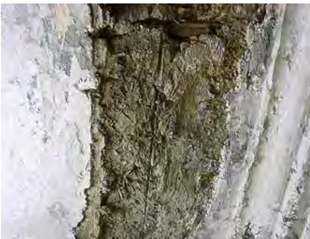
Abb. 5: Fehlstelle in der Stuckatur, Vorrizung im Lehmuntergrund
