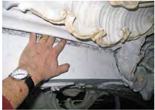
Abb. 24. Schäfte, Klosterkirche, Relativverformung zwischen östlicher Gewölbekuppel (Chor) und westlichem Gurtbogen
