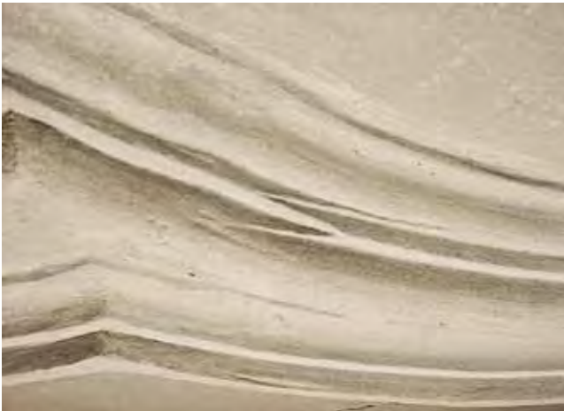
Abb. 7: Schablonenspur in der Stuckprofilierung
