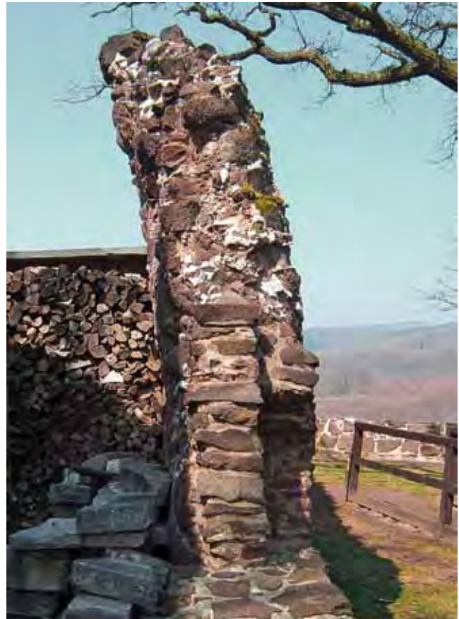
Abb. 4: Neustadt/Harz, Burgruine Hohnstein, Mauerwerksverformung durch Kriechprozesse im wechselfeuchten Gipsmörtel
