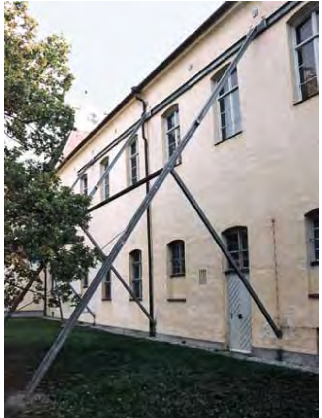
Abb. 16: München, Schloss Nymphenburg, Rückseite der ehem. Orangerie (Erdgeschoss) und des Hubertussaaes (Obergeschoss) im nördlichen Seitenflügel, provisorische Abstützung der Nordwand
