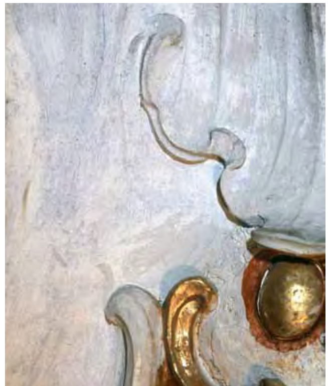
Abb. 14: Ottobeuren, Lkr. Memmingen, Basilika St. Alexander und St. Theodor, Johann Michael Fischer 1766, Nepomuk-Kapelle, bauzeitlicher Farbbefund mit Smalte und grauen Farbrepaturen der 60er Jahre
