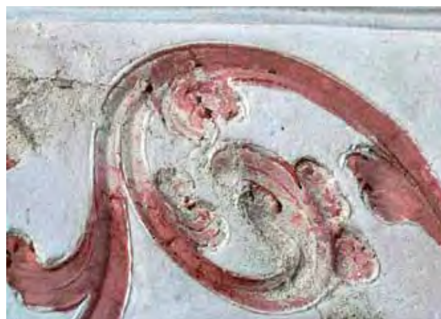
Abb. 2: Strassbach, Lkr. Dachau, St. Ottilia, Details der Schäden (Foto: Restaurierungswerkstätten Erwin Wiegerling)
