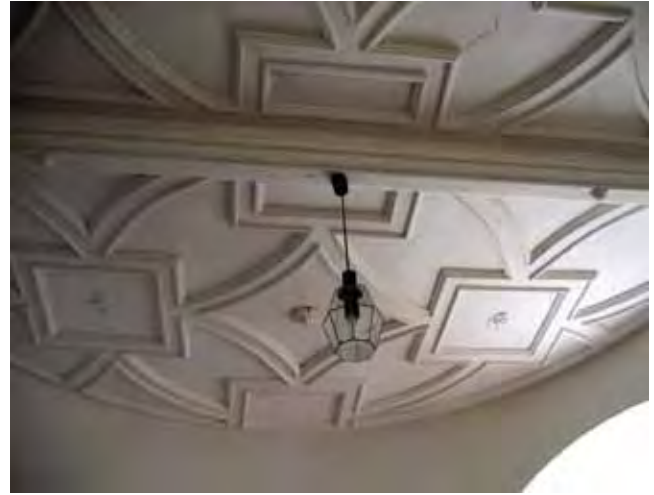
Abb. 2: Schloss Grumbach, Juliusturm, Deckenstuck im ersten Obergeschoss (2007)
