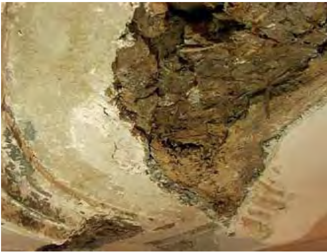
Abb. 15: Wasserschaden – Auswaschung und Zermürbung des Lehmgefüges
