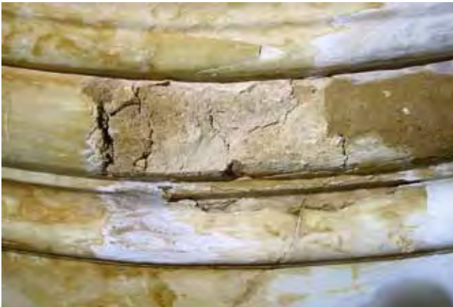
Abb. 14: Schloss Thalheim (Lkr. Nürnberger Land), Detail einer Stuckdecke mit Verfärbungen und Strukturschäden nach Brandschaden und damit verbundenem Löschwassereintrag, Zustand vor der Restaurierung 2005
