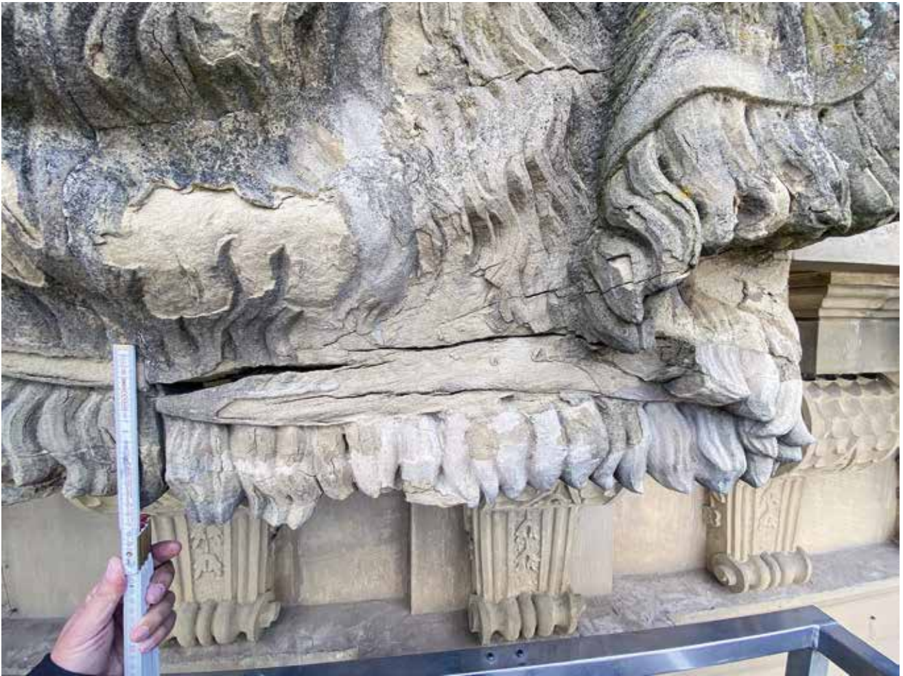
Abb. 9 Schadensdetail am südlichen Hermelinfell. Hier sind fast alle Schadbilder an einem Detail ablesbar (Foto M. Rycek)
