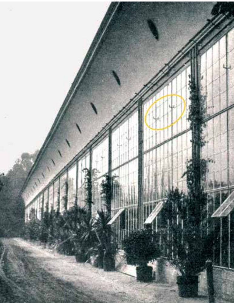
Abb. 11 Orangeriegebäude, Südfassade, Haken zur Befestigung von Beschattungselementen (Foto um 1902 mit Ergänzungen 2021, Sebastian Vãth, BSV, Gãrtenabteilung, Fotogrundlage: siehe Abb. 5)
