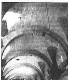
Condición vulnerable de bóveda y arcos fajones de nave mayor
