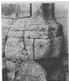
Basamento de portada lateral en proceso de disgregación
