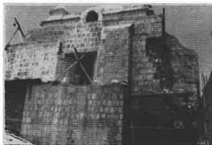
Andamiaje masivo hacia sector de testero colapsado
