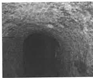
Deformación por presión del terreno de galerías revestidas de ladrillo.
