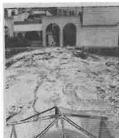
Liberación de carga sobre bóveda de capilla lateral (Muro de la epístola)
