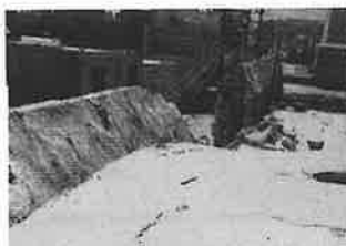
Fisura sobre cubierta del Oratorio
