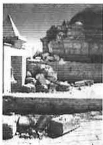
Desprendimiento de mampuestos sobre coro desde arco inmediato a torre
