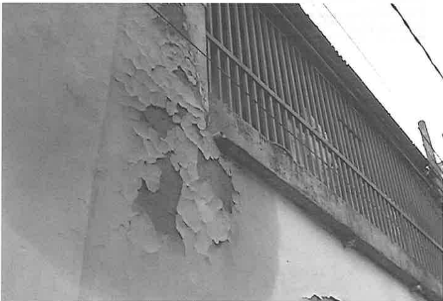
Foto 2: Balconada y revoco de fachada de tapial en mal estado.
