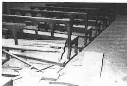
Colapso de mampostería de bóveda de nave mayor sobre el piso
