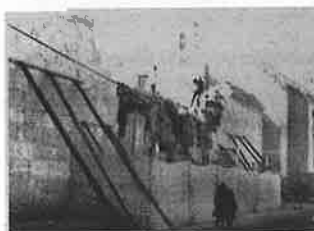
Sección de muro colapsado. Primera etapa de los trabajos
