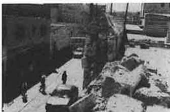
Vista del muro perimétrico colapsado hacia la calle Peral
