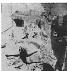
Registro de las piezas dispersas sobre cubierta próxima a muro colapsado
