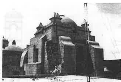
Fisuras en muro testero (inmediato a SEAL) con desprendimiento masivo en esquina
