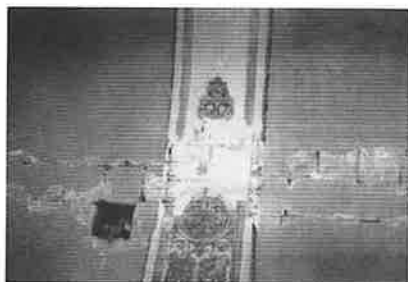
Daños en el tercio central del arco fajón
