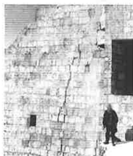
Daños en el exterior de muro del evangelio (presbiterio)
