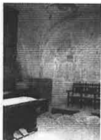
Colapso de mampostería de bóveda de nave mayor sobre el piso
