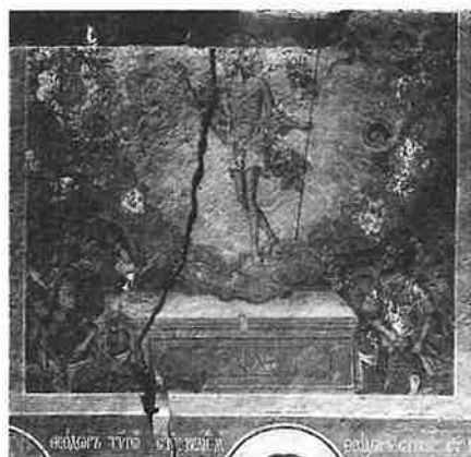
Fig. 5. Scène La Résurrection du Christ (naos, mur nord); décollement de l'enduit du mortier (éclairage latéral)
