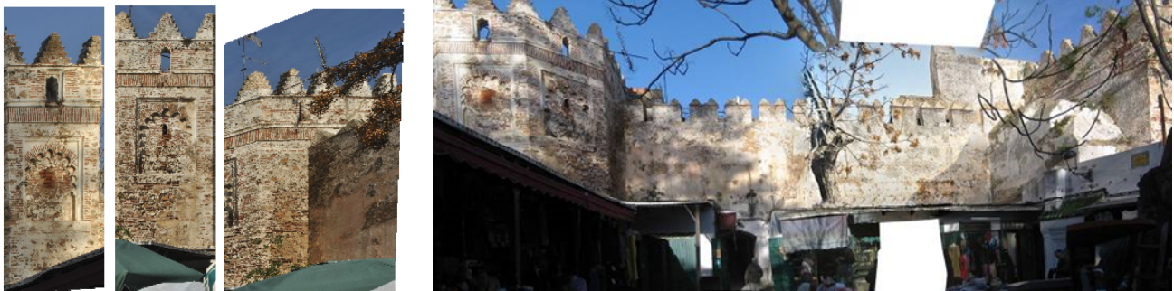
fig 2. Ortofotografías resultantes de ambos procesos: caras a, b y c de la torre central y lienzo de muralla SO
