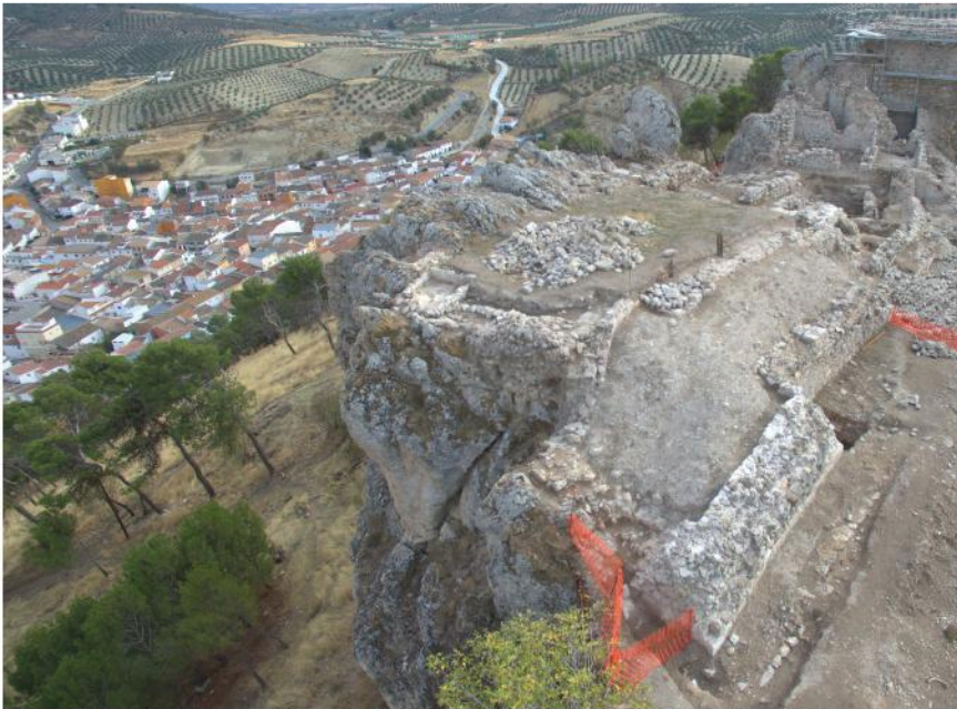
fig 4. Actuaciones de consolidación previstas en las estructuras murarias del Castillo de Montejicar.
