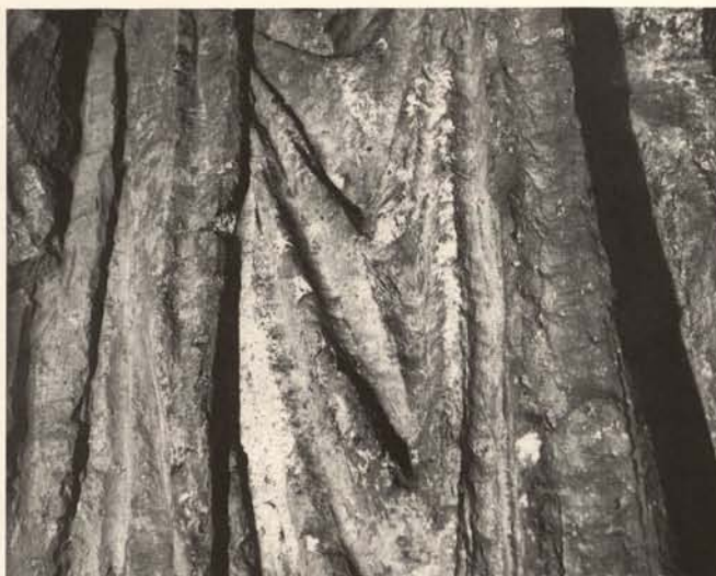
Abb. 196. Goslar, Vorhalle der ehem. Stiftskirche St. Simon und Juda, Giebelfeld, Detail der rechten Herrscherfigur. Dokumentation charakteristischer Schadensbilder: Stuckaufbrüche entlang vorstehender Gewandfalten.
