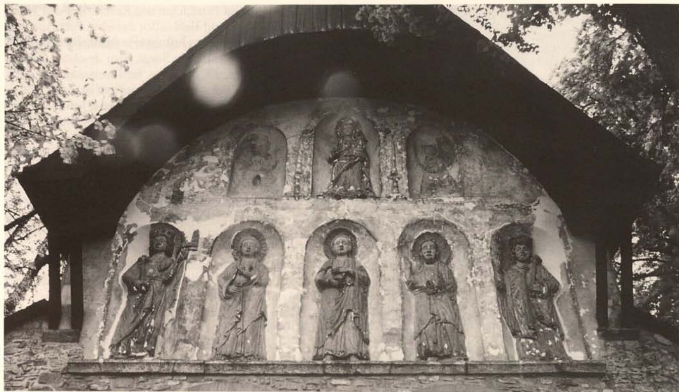
Abb. 189. Goslar, Vorhalle der ehem. Stiftskirche St. Simon und Juda, Giebelfeld. Zustand nach Abschluß der Konservierung mit hell sich abzeichnenden Kalkmörtelergänzungen (1990).
