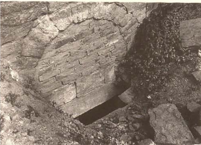
Abb. 75. Hildesheim, Dom, Bogenfeld in der Ostwand des nördlichen Querhauses nach Freilegung und erneuter Vermauerung (um 1948).
