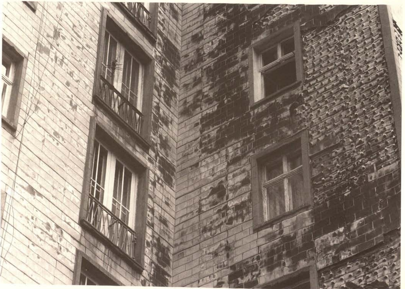
Fassadenausschnitt: die ursprüngliche Keramikbekleidung ist an vielen Stellen bereits durch Kunststoffplatten ersetzt worden, die ebenfalls wieder abgängig sind (Karl-Marx-Allee 123)
