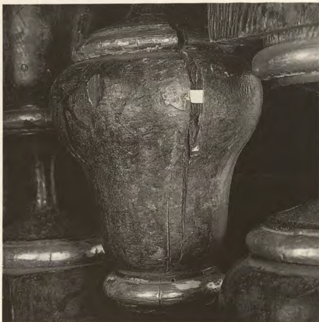
Abb. 2. Markgräfliches Opernhaus Bayreuth, starke Rißbildung an den hölzernen Balustern
