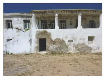
EFEITO DA ÁGUA NÃO DRENADA NA CAFETERIA (REFORMADA EM 2009)
