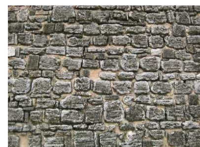
5. Stuccatura "sottosquadro" realizzata da UNESCO presso il portale della fortezza, fra il 2008 e il 2010. Questa tecnica, conforme agli standard attuali del restauro architettonico, è ormai alla portata degli artigiani locali. (M.B. 2016)
